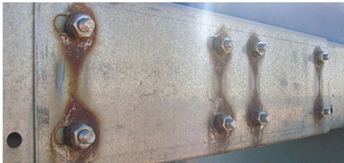
Korrosjon på bolter i en stålbejelke. https://www.oglaend-system.com/solutions/materials/corrosion/
