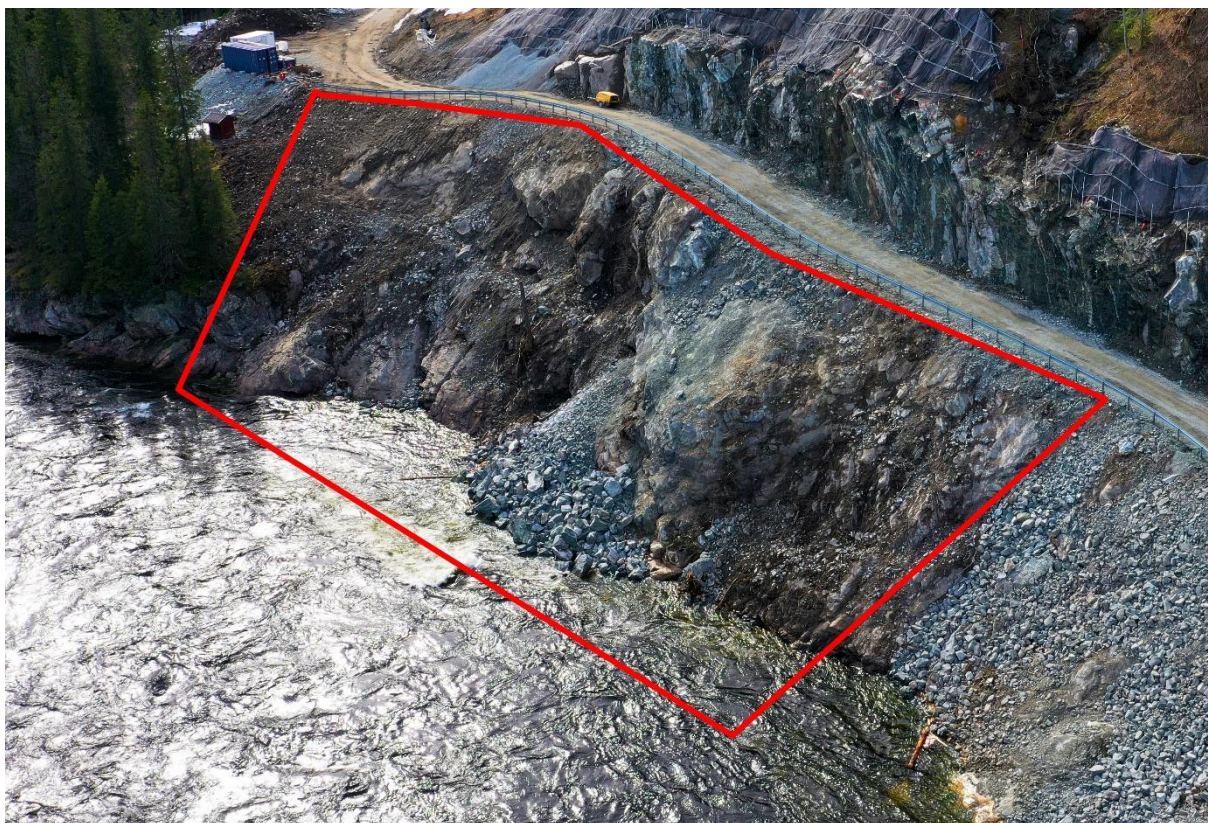
Figur 8: Bilde av vegskjæringen i området pel 650 til pel 780 (problemområdet). Innringet vises ras som har gått ut i elven. Bilde tatt av Skanska.
