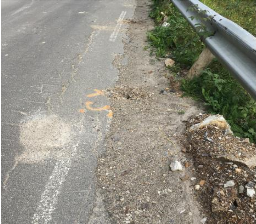
Fig 15: Kantskade pga. mulig uegnet skråning, fv. 515 Nordland
