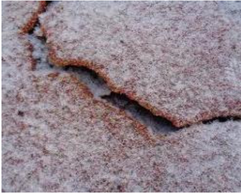
Figur 8.1. Eksempel på skade på gummidekke
