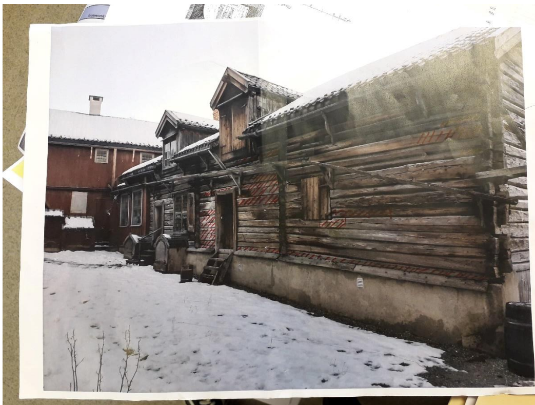
To bilder over: Sidefløyen våren 2019. Tømmer med rød skravering må skiftes ut. Sverresborgs egen dokumentasjon.
