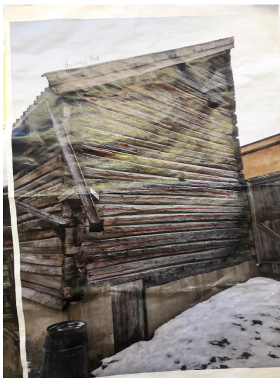
Gavl-veggen på sidefløyen våren 2019. Mye av tømmeret må skiftes ut. Sverresborgs egen dokumentasjon.
