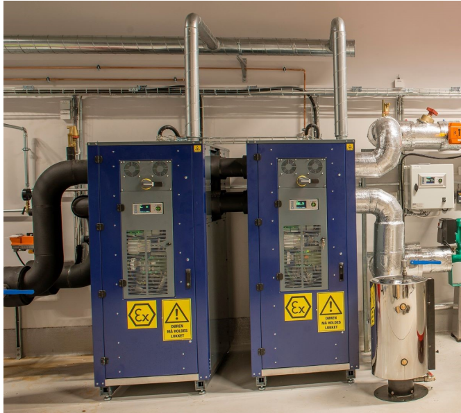
(a) Enrad væske/vann-varmepumpe (P. A. Aaslund, personlig kommunikasjon, 20. mai, 2019) Ventilerte kabinett med varmelytelse 59–136 kW, maksimalt 5 kg fyllingsmengde.
