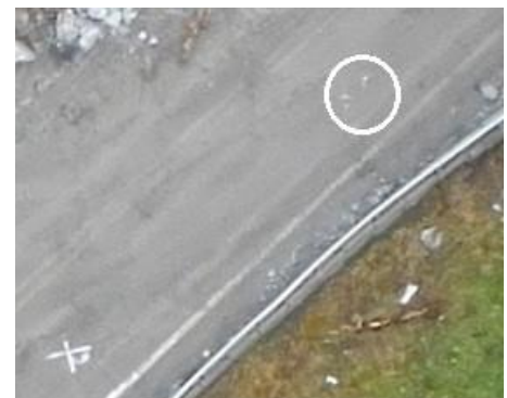
Figur 15: Spraymaling som er slitt bort
