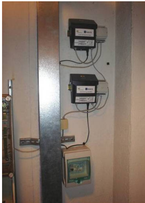
Figur 7.8: Eksempel på installasjon av PLC anlegg fra OPERA testprosjektet i Madrid, Spania.
