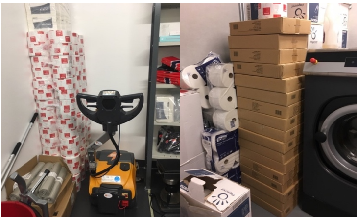
Figur 11: Elektroniske komponenter tett på lagring av brennbart materiale, Årvoll
