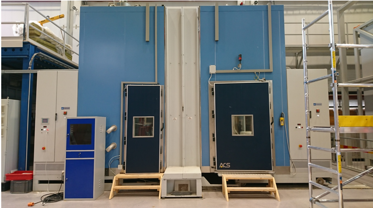
Figur 11: Klimasimulatoren på laboratoriet til NTNU og SINTEF Byggeforsk. Døren til venstre går inn til kammeret med uteklima og døren til høyre går inn til kammeret med inneklima. Testveggen er satt mellom to kammersene
