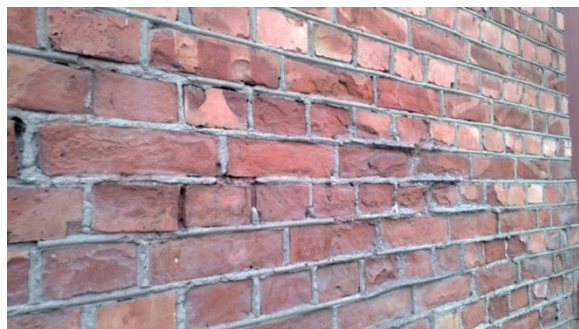
Figur 3: Frostskafer i eldre teglsteinsfasade [9]. Bildet viser hvordan gjentatte fryse- og tinesykluser kan føre til frostsprengning.
