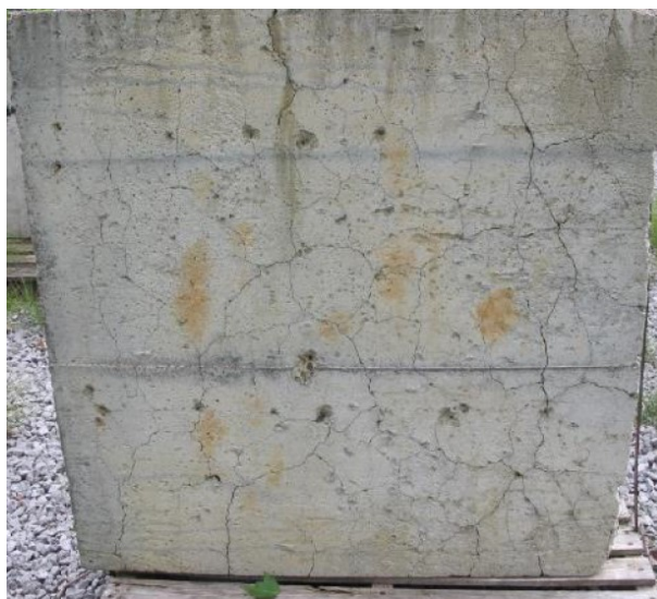
Figur 2-4: Krkeleringsmønster/rissdanning (Rodum et al., 2018)
