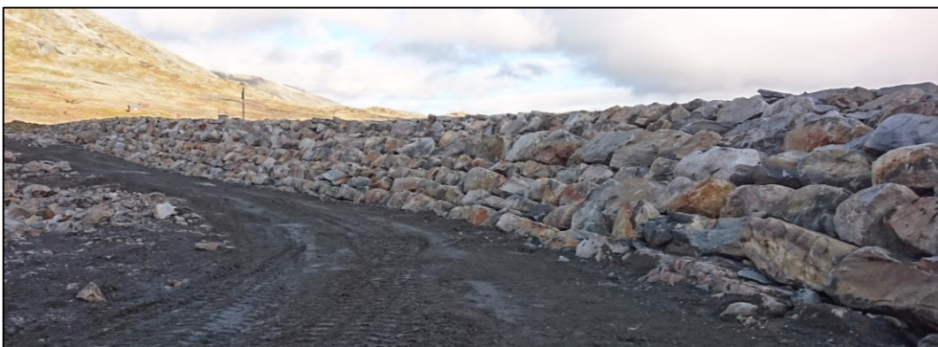
Figur 7-4: Eksempel på plastring, nedstraumsside (Tafjord Energi, Dam Kolbeinsvatn)
