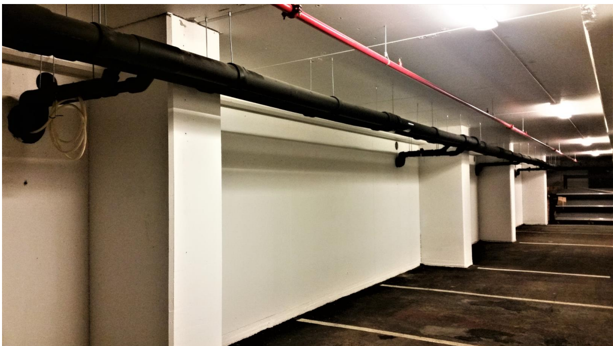
Figur 3.3 Kollektorslanger fra energibrønnene ført inn i første underetasje (U1).
