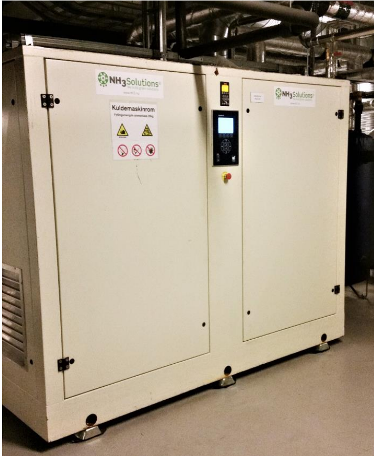
Figur 3.6 Varmepumpe/kjølemaskinen ved Swecobygget. Aggregatet er bygget inn i et støydempet kabinett som også hindrer ammoniakk utslipp i teknisk rom ved eventuell lekkasje under drift.
