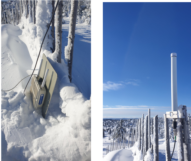
Figur 24: Basestasjonen og antennen satt opp for testing.
