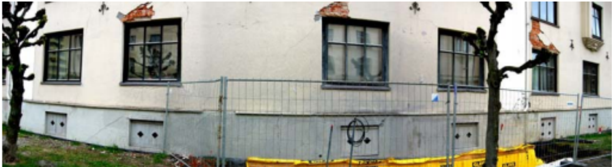
Figur 14. Setningsskader på fasaden på et bygg i Gardeveien (Magnussen og Kveldsvik, 2003).
