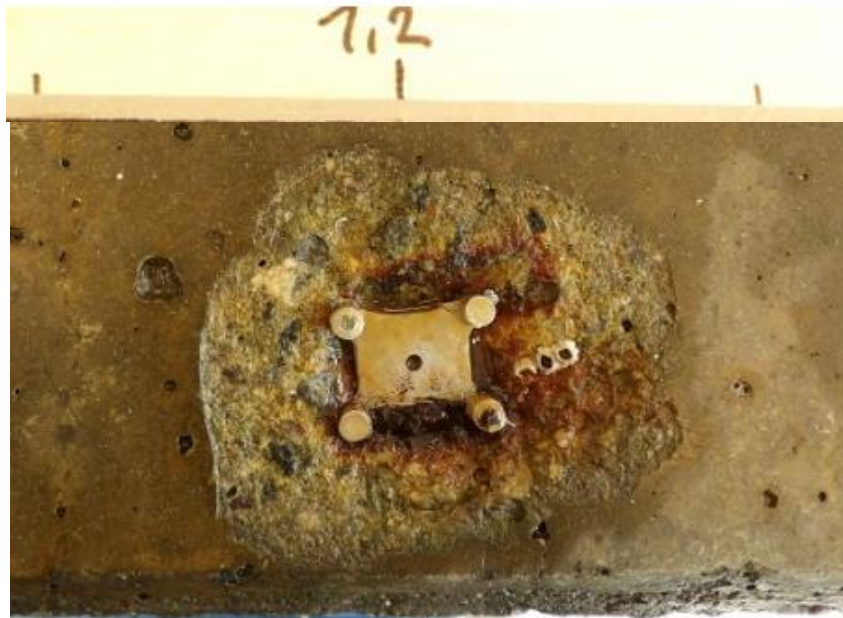
Figur 5.3: Avskalling rundt armeringsstol ved ca. 1,2 m for linje 2. Synlig rustutslag rundt armeringsstol.
