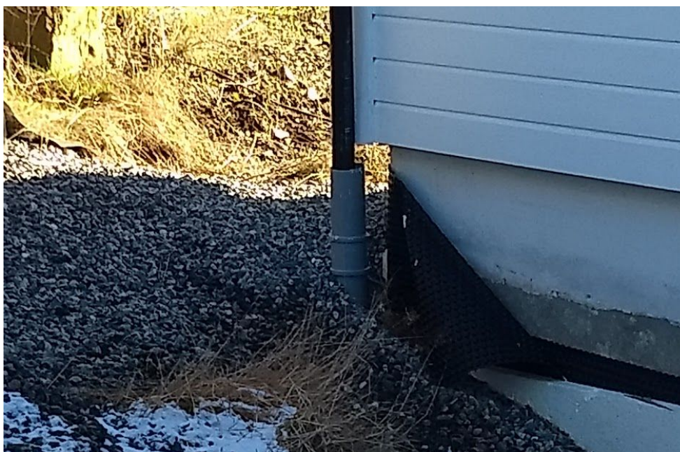
Figur 29. Bilde av takrenne som er koblet til spillvannsledning som ble tatt under befarings
