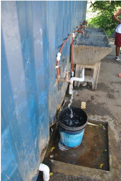
Vaskekummer og vannkran på utsiden av CAB.
