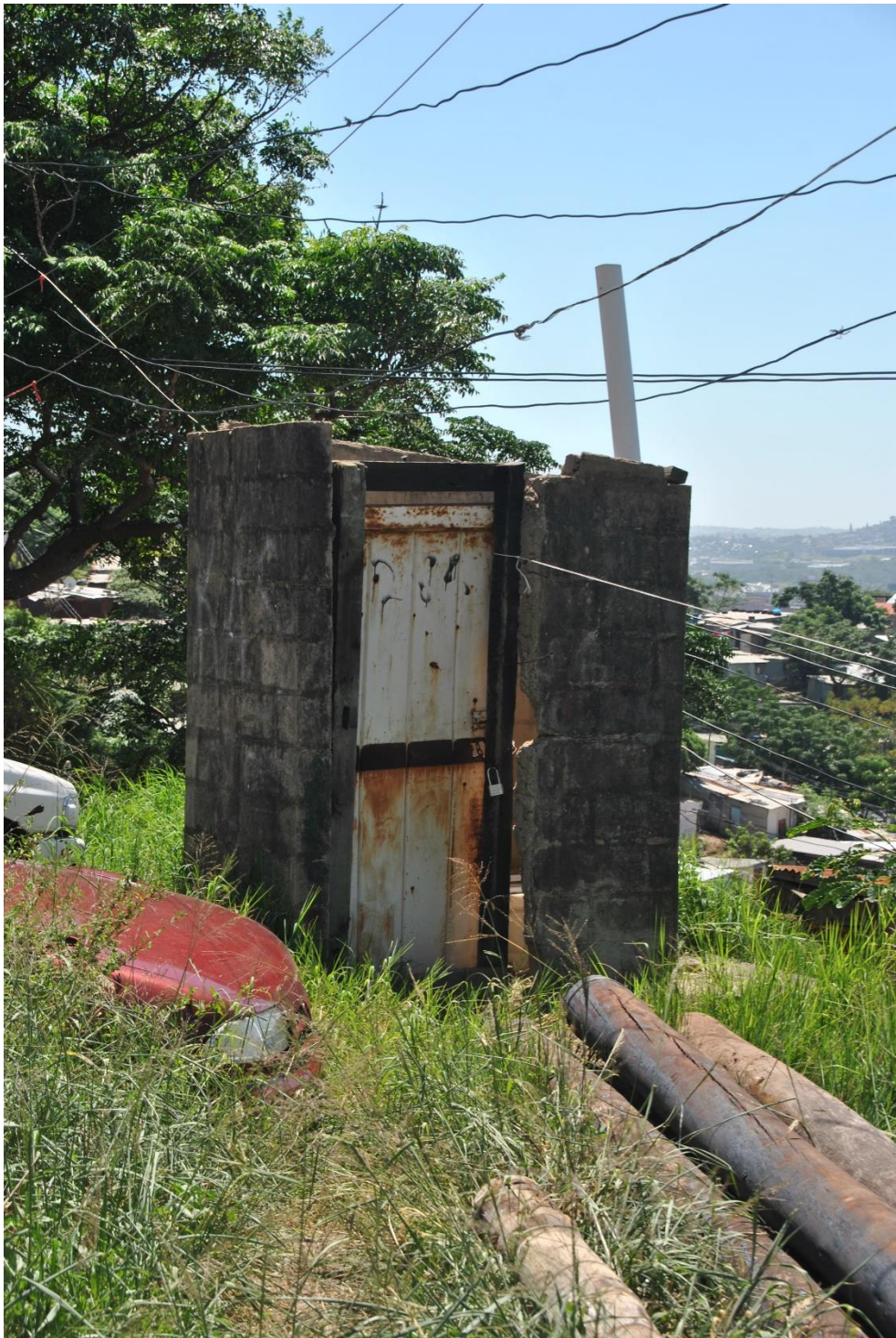
Latrine i svært dårlig stand.
