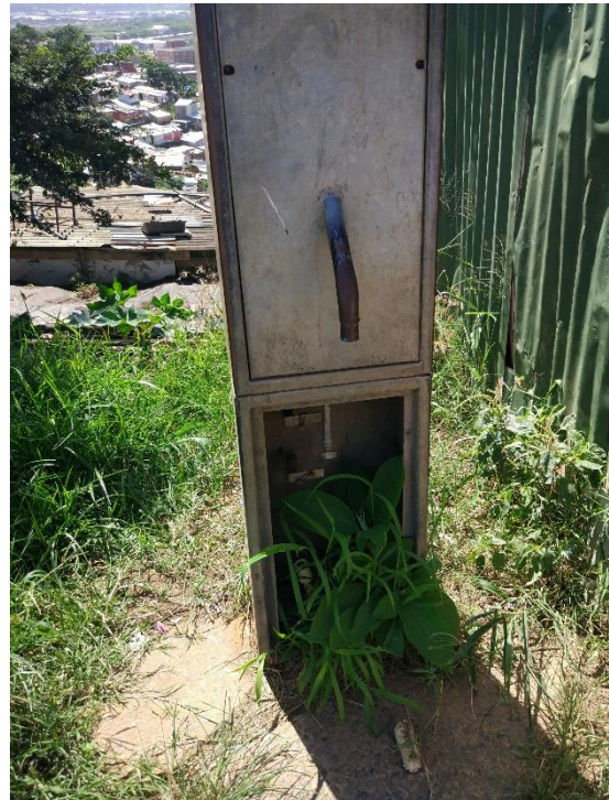
«Standpipe» som er ute av drift.
