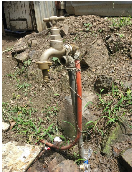
En ulovlig oppsatt vannkran.
