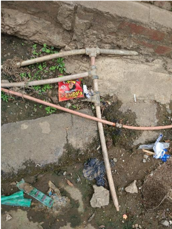
Synlige rørkoblinger i overflaten.
