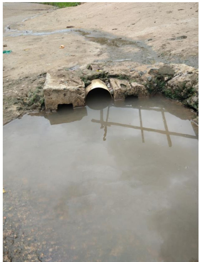
FIGUR 17 RØR FOR Å AVLEDE AVRENNINGSVANN ER TILSYNELATENDE BLOKKERT. DURBAN, FEBRUAR 2019
