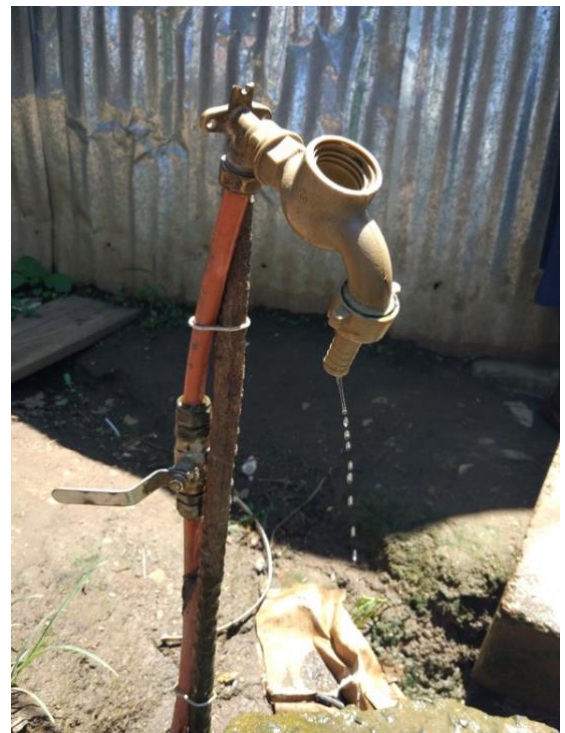
FIGUR 20 EN ULOVLIG OPPSATT VANNKRAN MED TYDELIGE MANGLER OG LEKKASJE. KENNEDY ROAD, DURBAN, FEBRUAR 2019.
