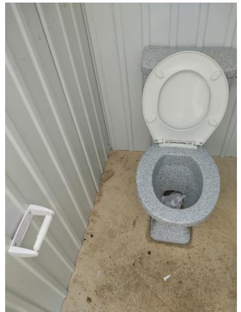
Flush-toalett inne i CAB. Merk: ingen toalettpapir tilgjengelig.
