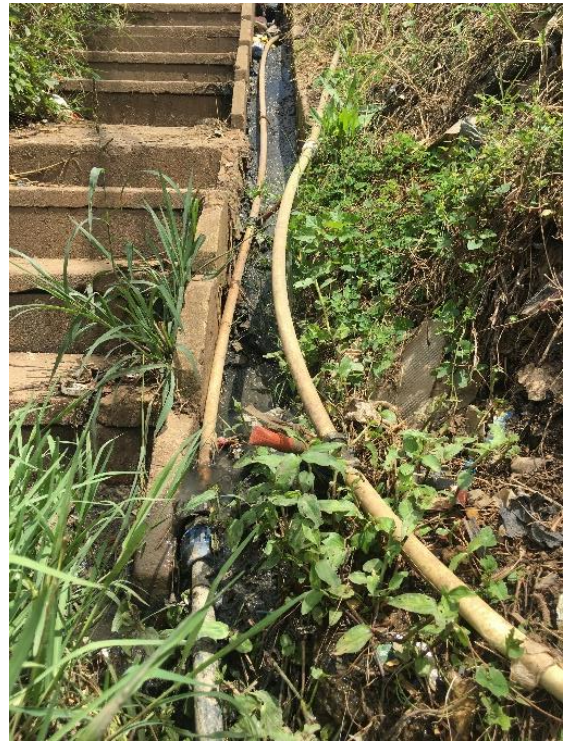
Vannledning plassert i overvannsrenne.
