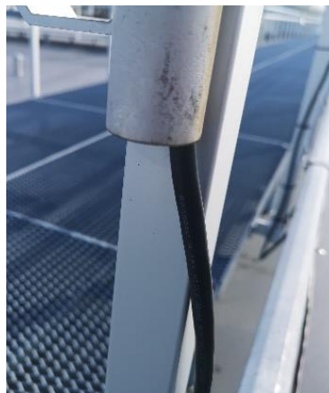
Figur 5 Kabelrør (foto: eget)
