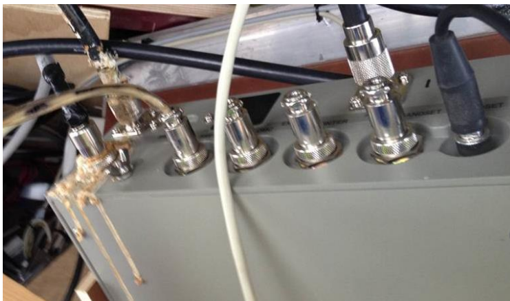
Figur 20 Vanninntrenging kabel (foto: Jostein Synes)
