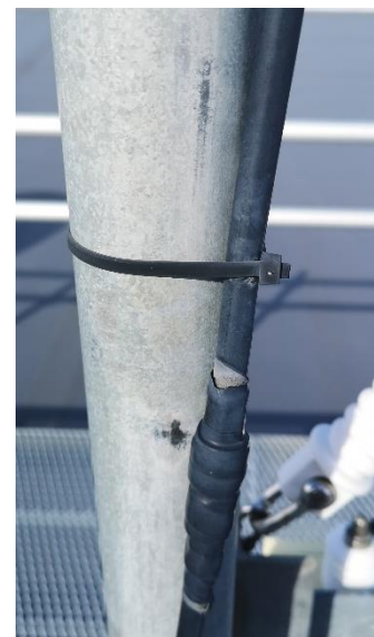
Figur 6 Brudd på isolasjon til antennekabel (foto: eget)
