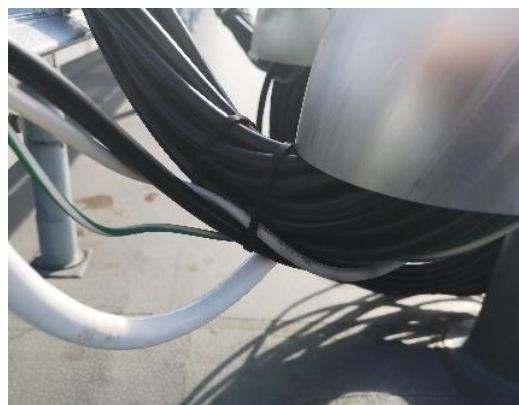
Figur 18 Kabelgjennomføring (foto: eget)
