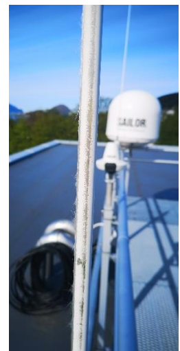
Figur 7 Oppfliset antenne (foto: eget)
