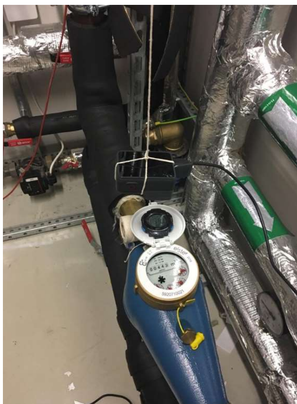
Figur 8: Oppsettet for logging av totalt vannforbruk Lade Sportsarena.
