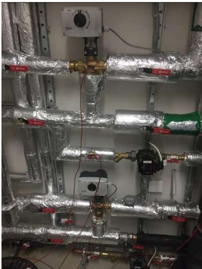
Figur 1: Visning av hvordan PT-100 elementene er montert på rørene i teknisk rom.
