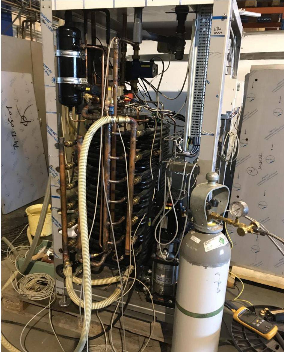
Bilde av varmepumpa. Eget bilde
