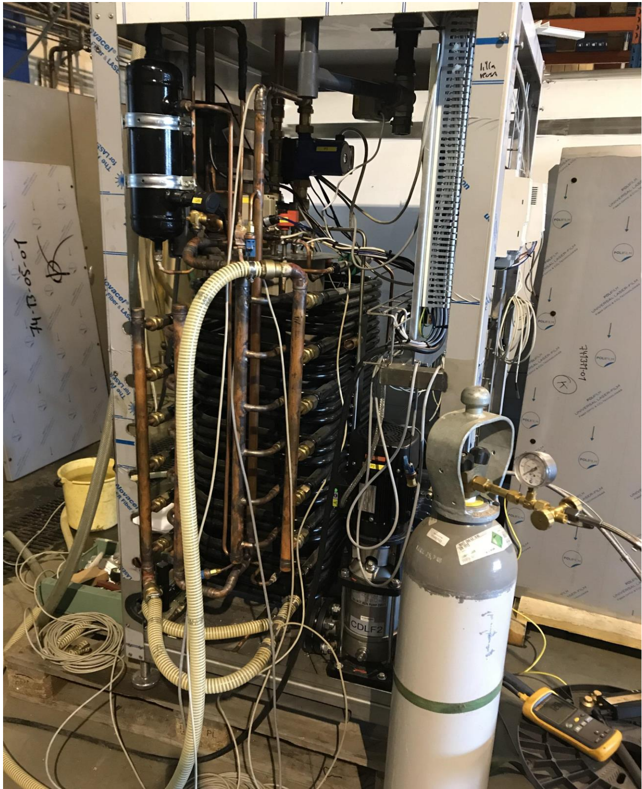
Varmepumpa i sin helhet. Eget bilde.
