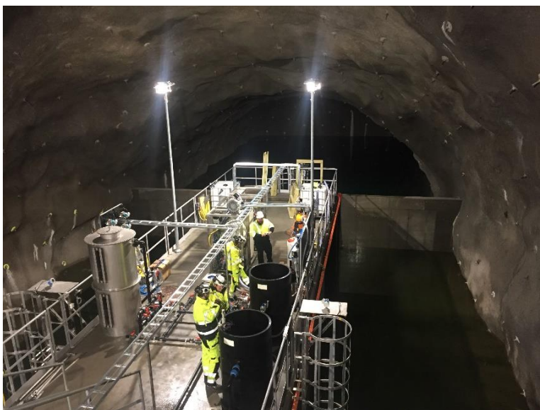
Figur 2-1: Renseanlegg i Bjørnegårdtunnelen (Foto: Christian Øveråsen, 2019)
