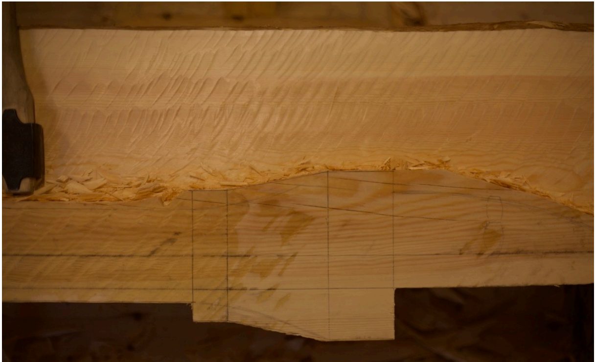
Bilde 41: Hogging av kanten av kapitelet mot veggiledelen. Fotograf: forfatter
