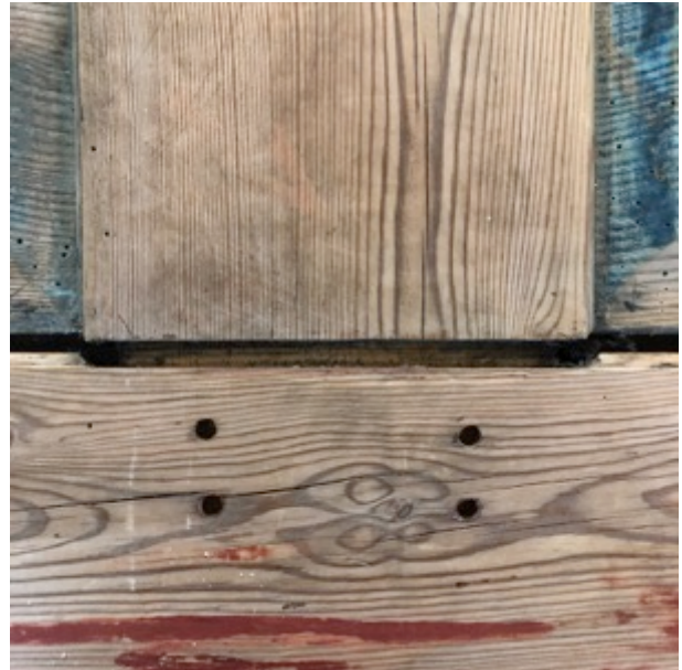
Figur 8 Riss ved brystning. Foto: RR
