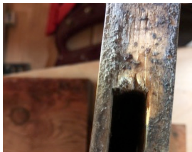
Figur 7 Riss i enden av tappholet. Foto: RR
