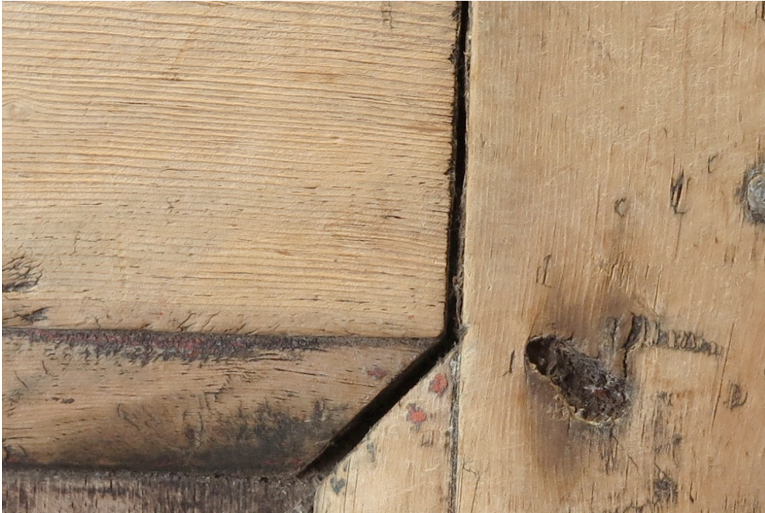
Figur 8. Riss. Foto: HTF
