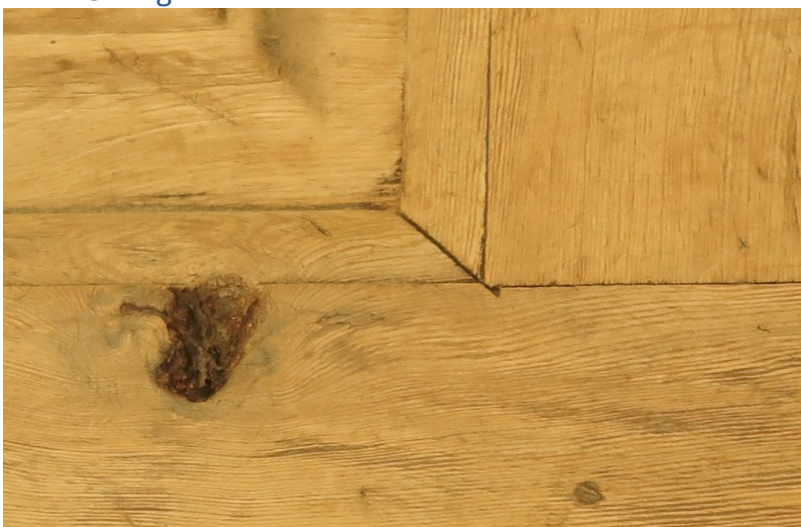
Figur 6. Gjæringsriss Foto: HTF
