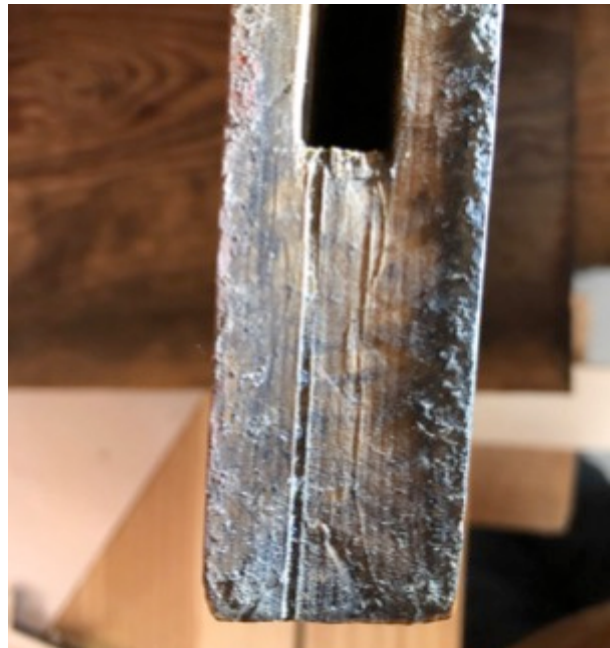
Figur 12 Notspor på brystningsflate. Foto: RR
