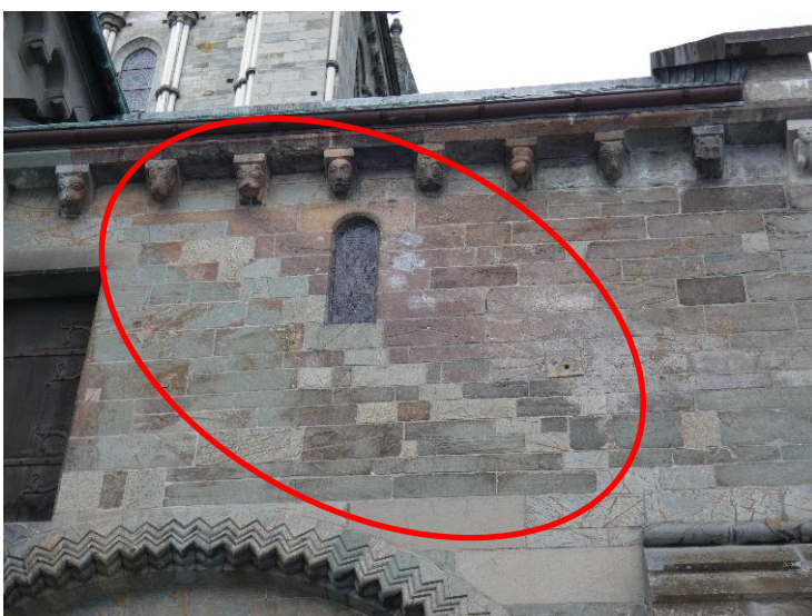
Olavskapellets søndre yttervegg, rød-brun misfarging på stein og konsoller, skrått nedadgående spor etter brannskade.
