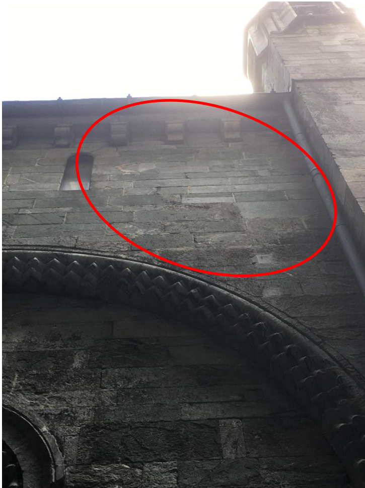
Mariakapellets søndre yttervegg, med rød-brun misfarging på stein og konsoller. Skrått nedadgående spor i vegg som viser forskjellig tilstand på steinene.
