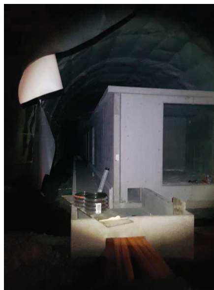
Figur 8: Teknisk bygg installert i nisje.
