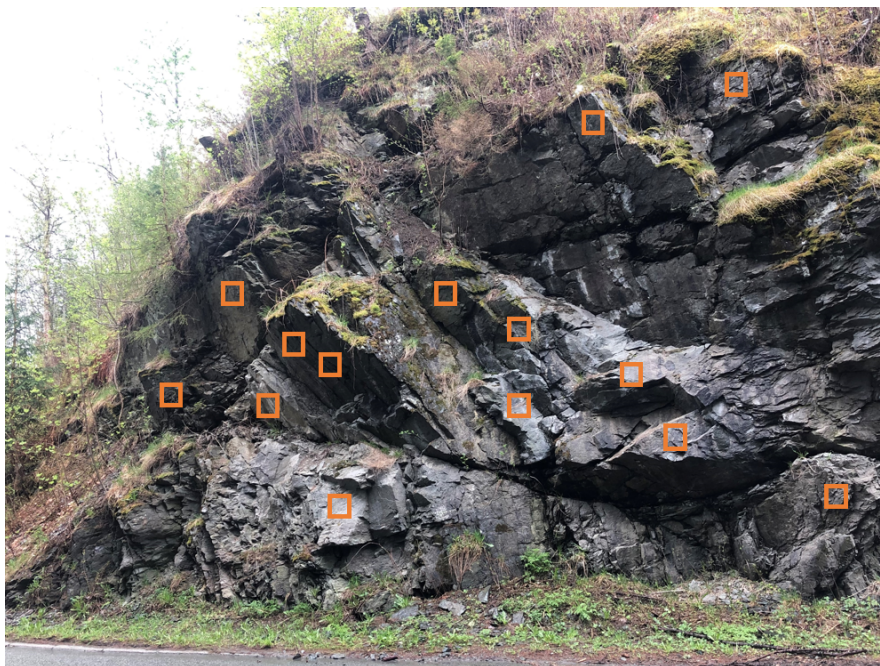
Figur 38: De oransje kvadratene viser hvor det anbefales å montere bolter. (Foto: A. E. Hollen)
