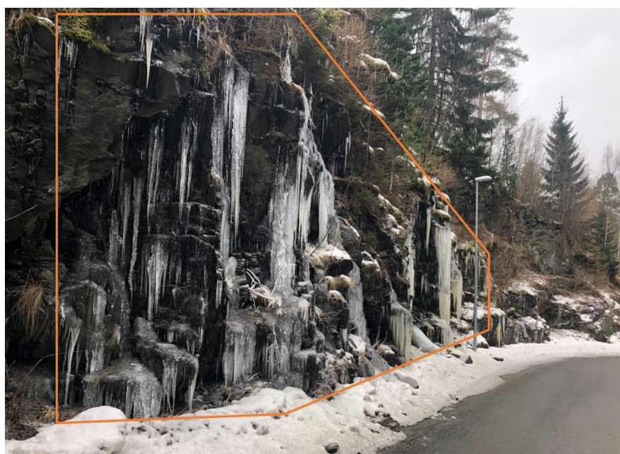
Figur 39: Innenfor det avgrensede området er det mye isdannelse og nett bør monteres. (Foto: A. E. Hollen)
