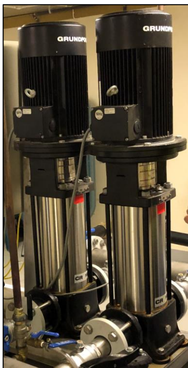
Figur 11: Foto – To Grundfos CR 16-70 A-F-A-BUBE pumper i vannbehandlingsanlegg på Eid
