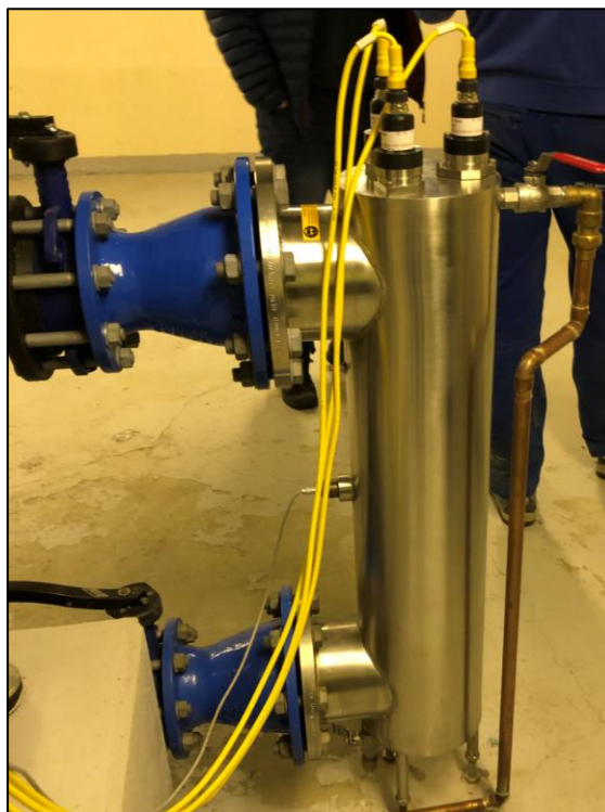
Figur 9: Foto – UV-reaktor i vannbehandlingsanlegg på Eid
