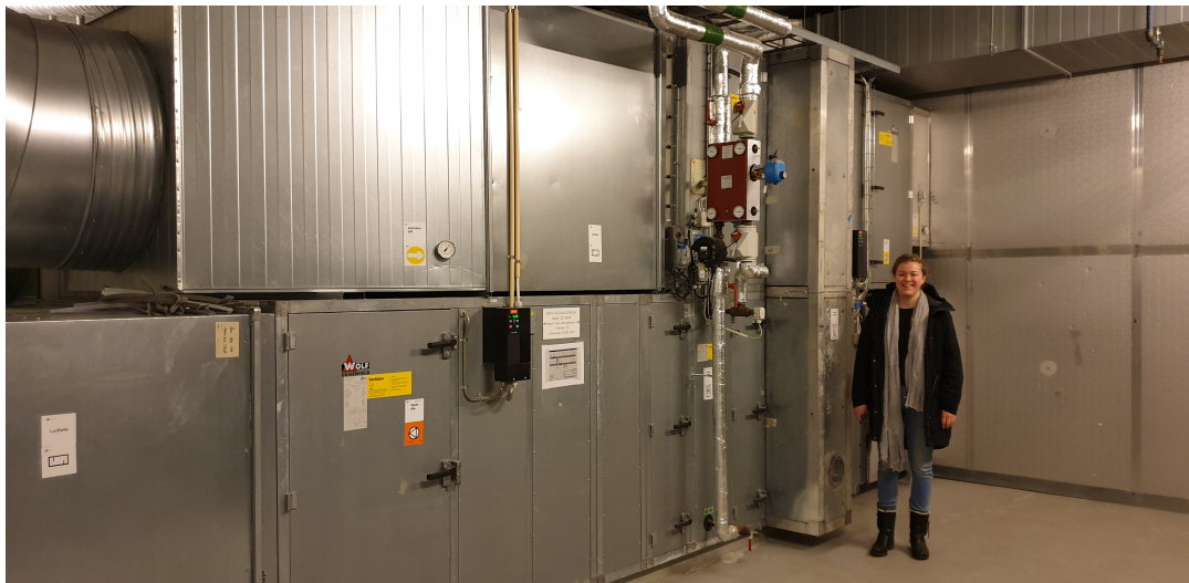
Figur 7: Ett av ventilasjonsanleggene med varmebatteri. [Eget bilde]
