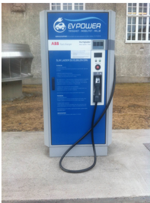
Figur 33 Hurtigladdestasjonen hvor målingene er gjort på.
