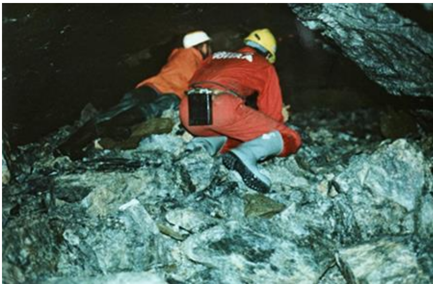
Fig. 2. Ras tilløpstunnel ved Kvanngabotn kraftverk etter mer enn 20 års drift.
