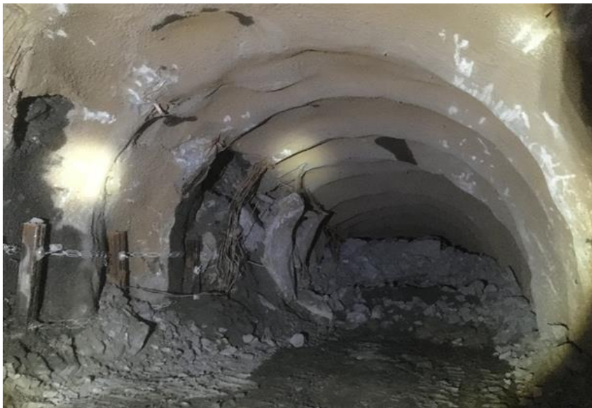
Fig. 3. Ras med innpressing av sikringsbuer i veggene i tilløpstunnel ved Matre Haugsdal.
