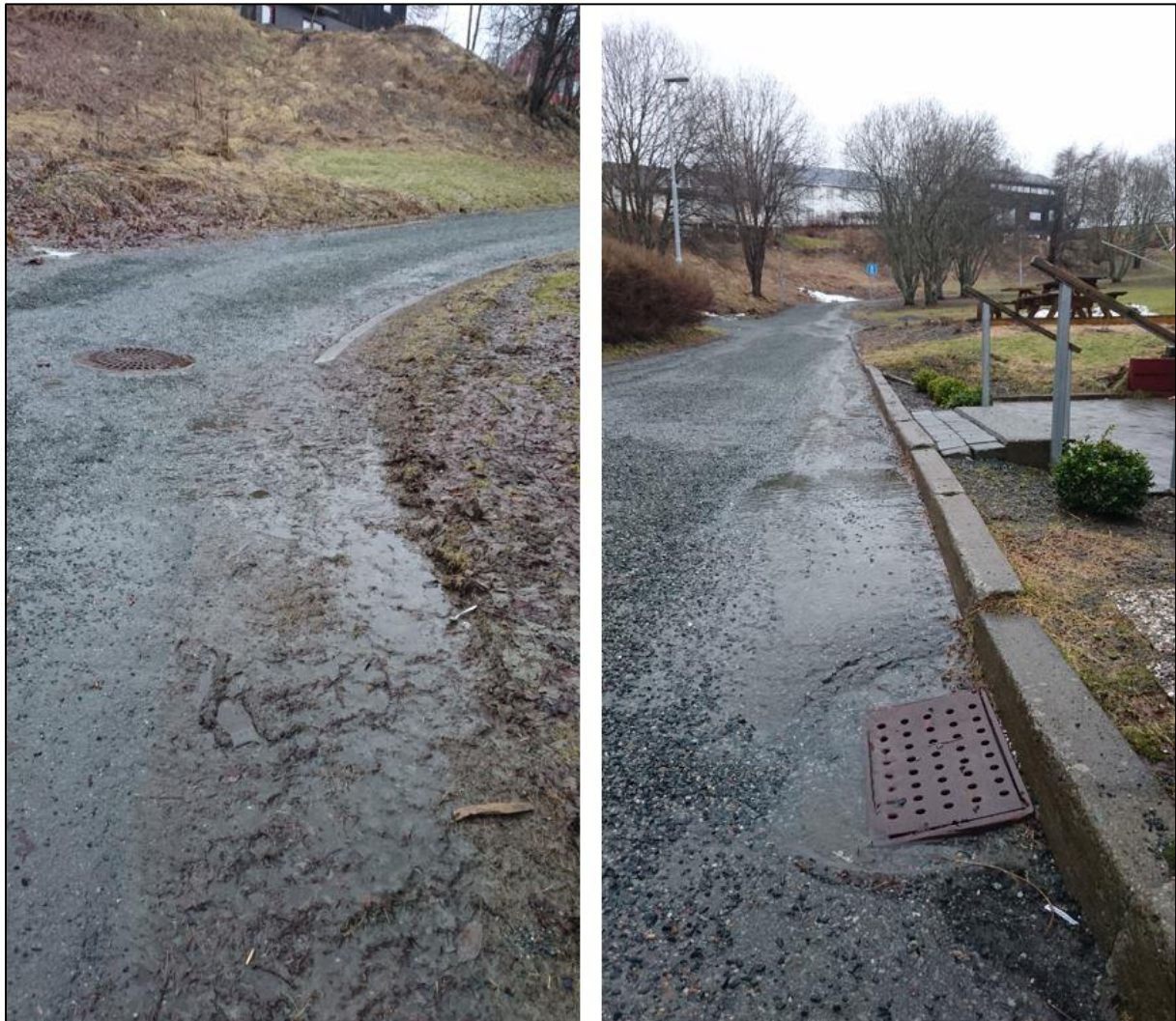
Figur 45: Bekreftet vannstrøm i felt. Til venstre: vannet renner ut av vegbanen ved punkt C. Til høyre: vannstrøm på vegens venstre side (sett mot nord) ved punkt D. Befaring 19.02.17.
