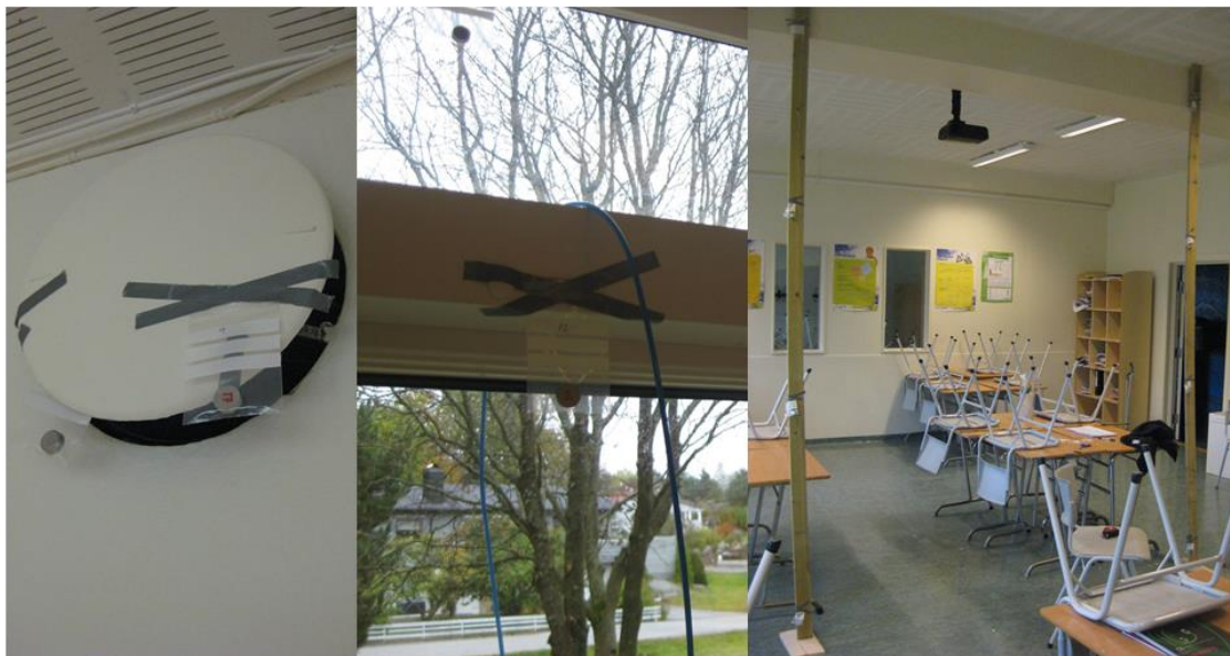
Figur 24: Fra venstre: Plassering av temperaturloggere ved avtrekk, vindu og i klasserommet
