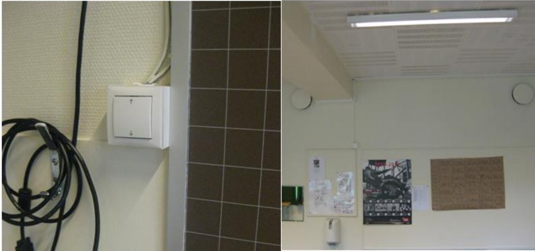
Figur 21: Fra venstre: Overstyringsknapp og plassering av sensor i klasserom 101
