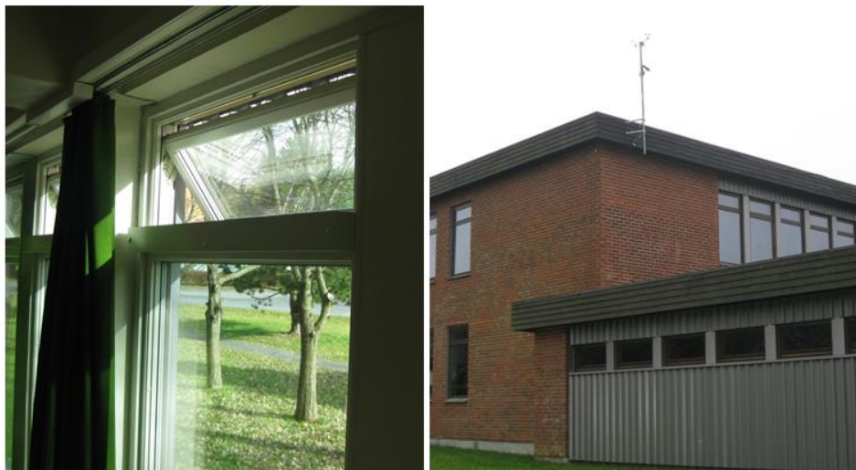
Figur 20: Fra venstre: Automatisk styrt vindu som benyttes for vinduslufting og værstasjonen på taket
