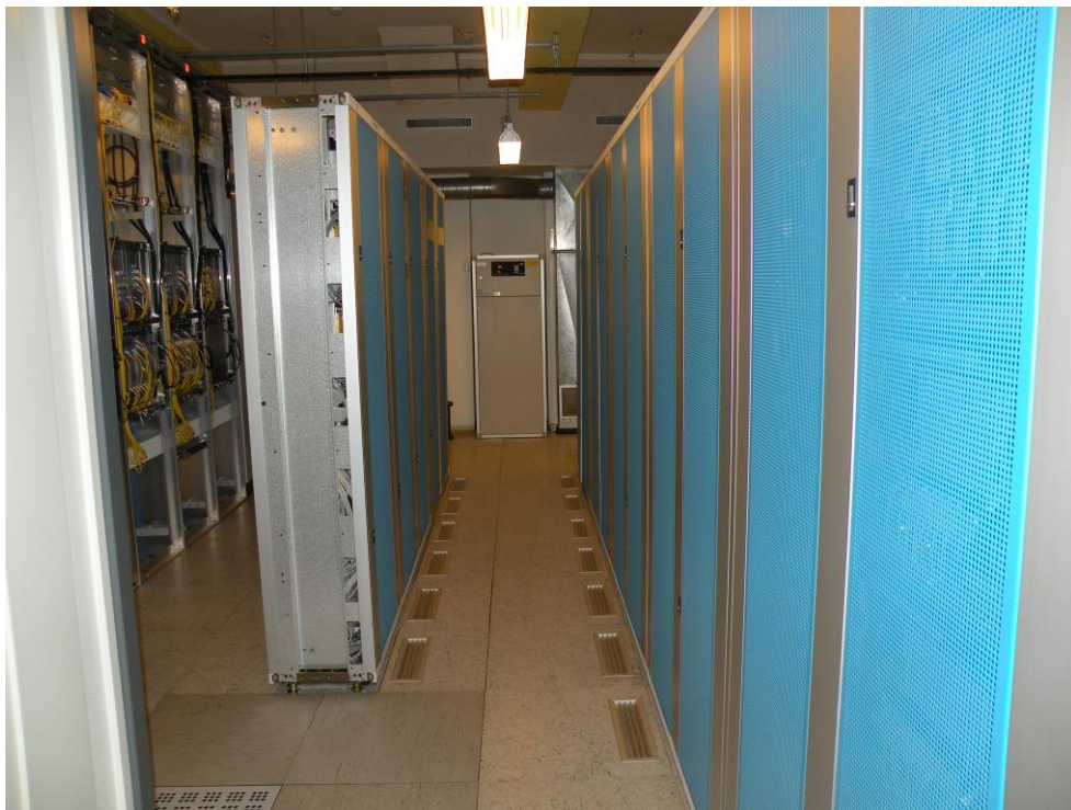
Figur 10 Radene med datautstyr. Kald luft kommer opp fra gulvet.
