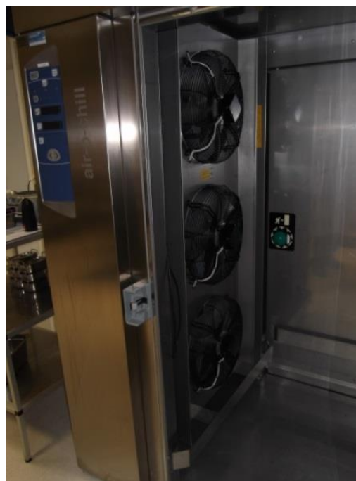
Figur 4 Hurtigkjøler i forsyningskjøkkenet
