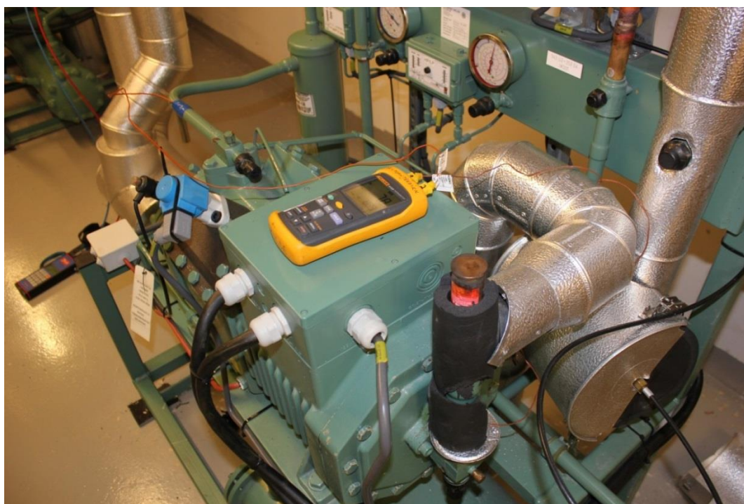
Figur 38 Hurtigkjøler utstyrt for måling av temperaturer og vannmengde
