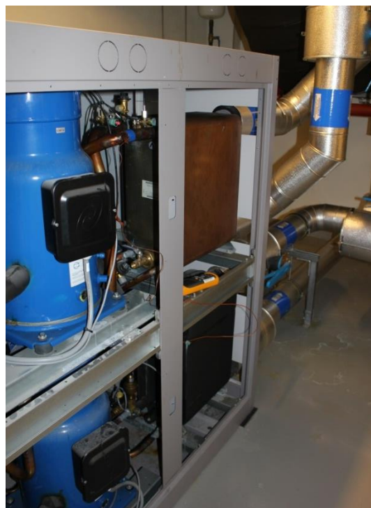
Figur 40 Kjølemaskin 1 under driftsmålinger
