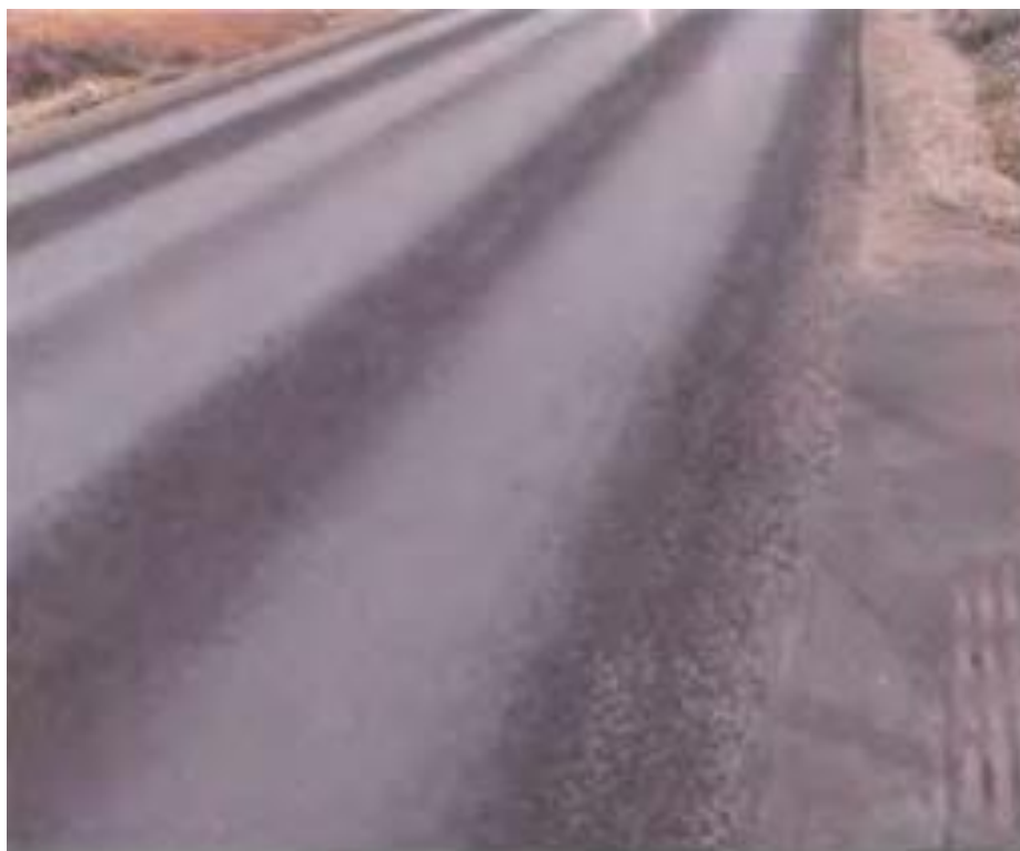
Figur 5 - «Blødning» i asfaltdekke. (Statens vegvesen, 2014c)
