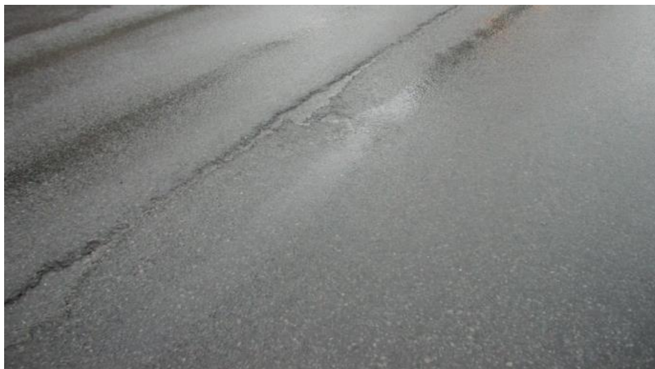
Figur 3 – Dekkeskader som skyldes høyt hulrom i skjøt. (Statens vegvesen, 2015a)
