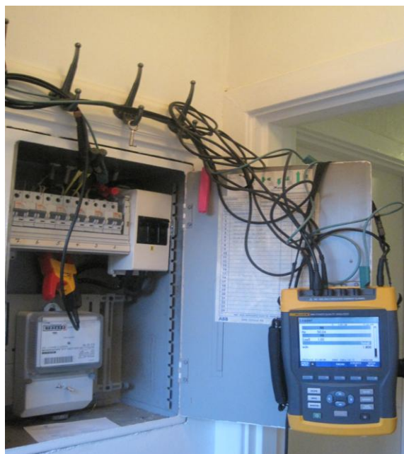
Figur 7-3 Bilde av oppsett av forsøk uten energi- og effektstyring
