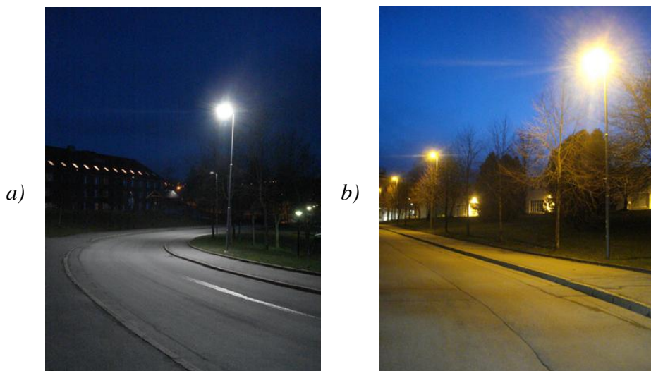
Figur 4-2: Forskjell i belysning i testanlegget, a) LED og b) NaH
