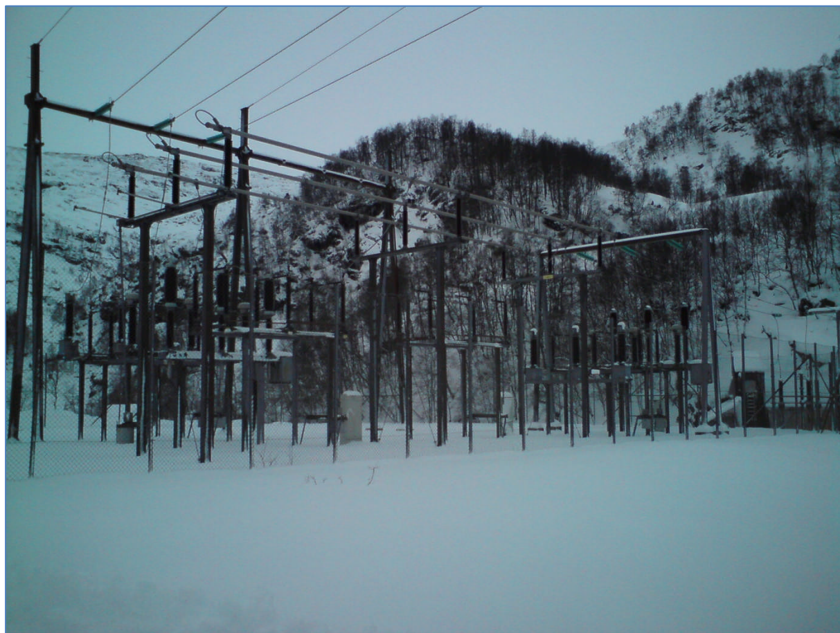
Figur 5.15: Utendørs apparatanlegg Kvittingen kraftverk [10]
