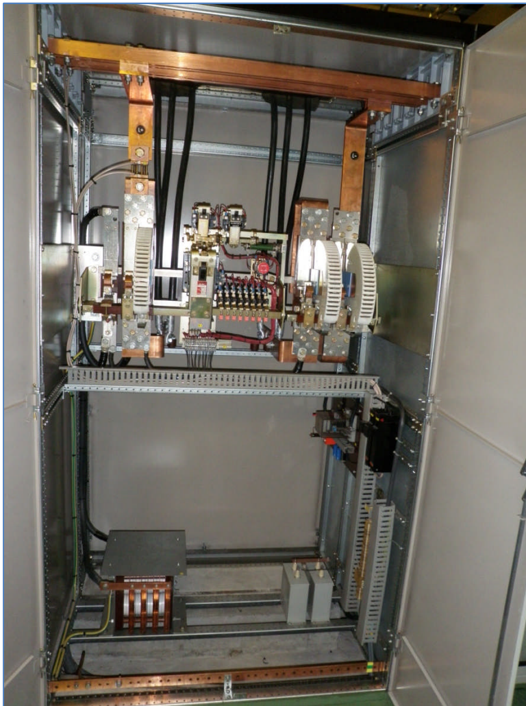
Figur 5.8: Skap for magnetisering i Kvittingen kraftstasjon [10]
