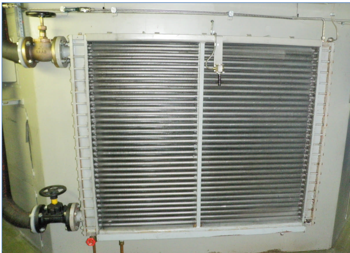
Figur 8.2: En av fire generatorkjølere i Kvittingen kraftstasjon [10]
