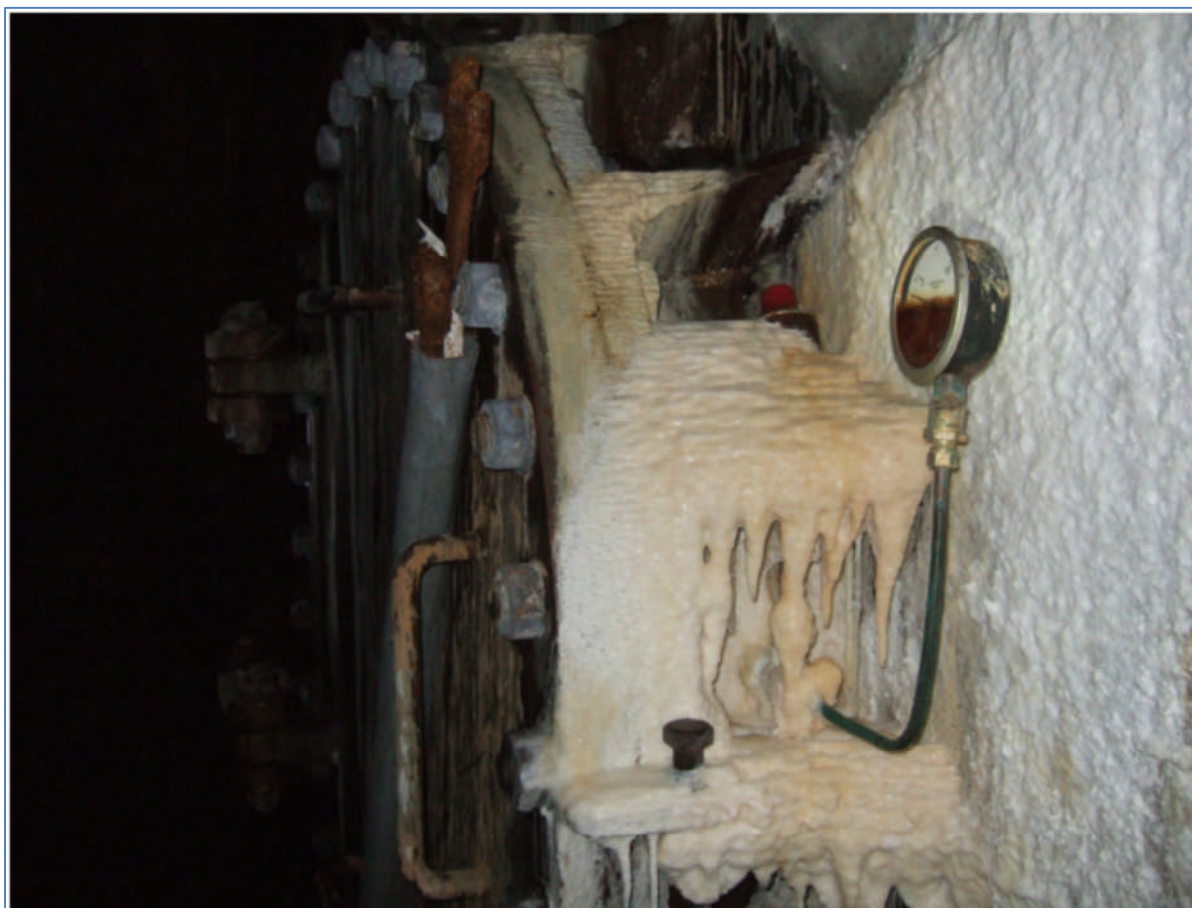
Figur 4.2: Kalkutfelling rundt lokk på tverrslagsport ved Dukebotn [11]
