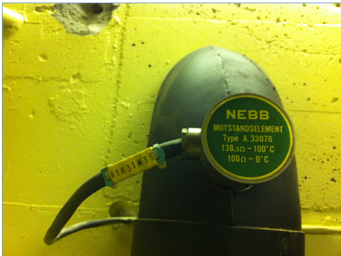
Figur 8.4: PT 100 element for måling av kjølevannstemperatur til generatorkjølere [10]
