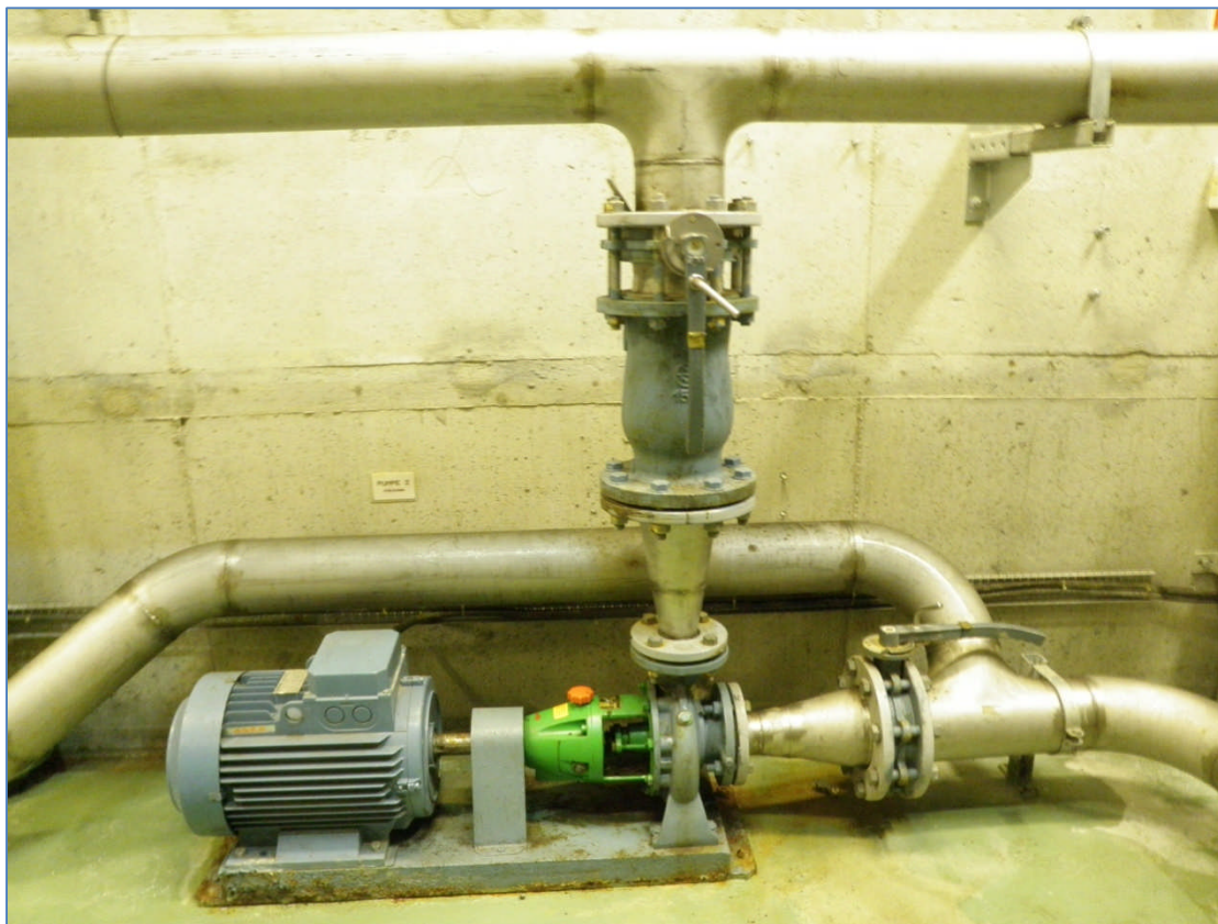
Figur 8.1: Kjølevannspumpe 2 i Kvittingen kraftstasjon [10]
