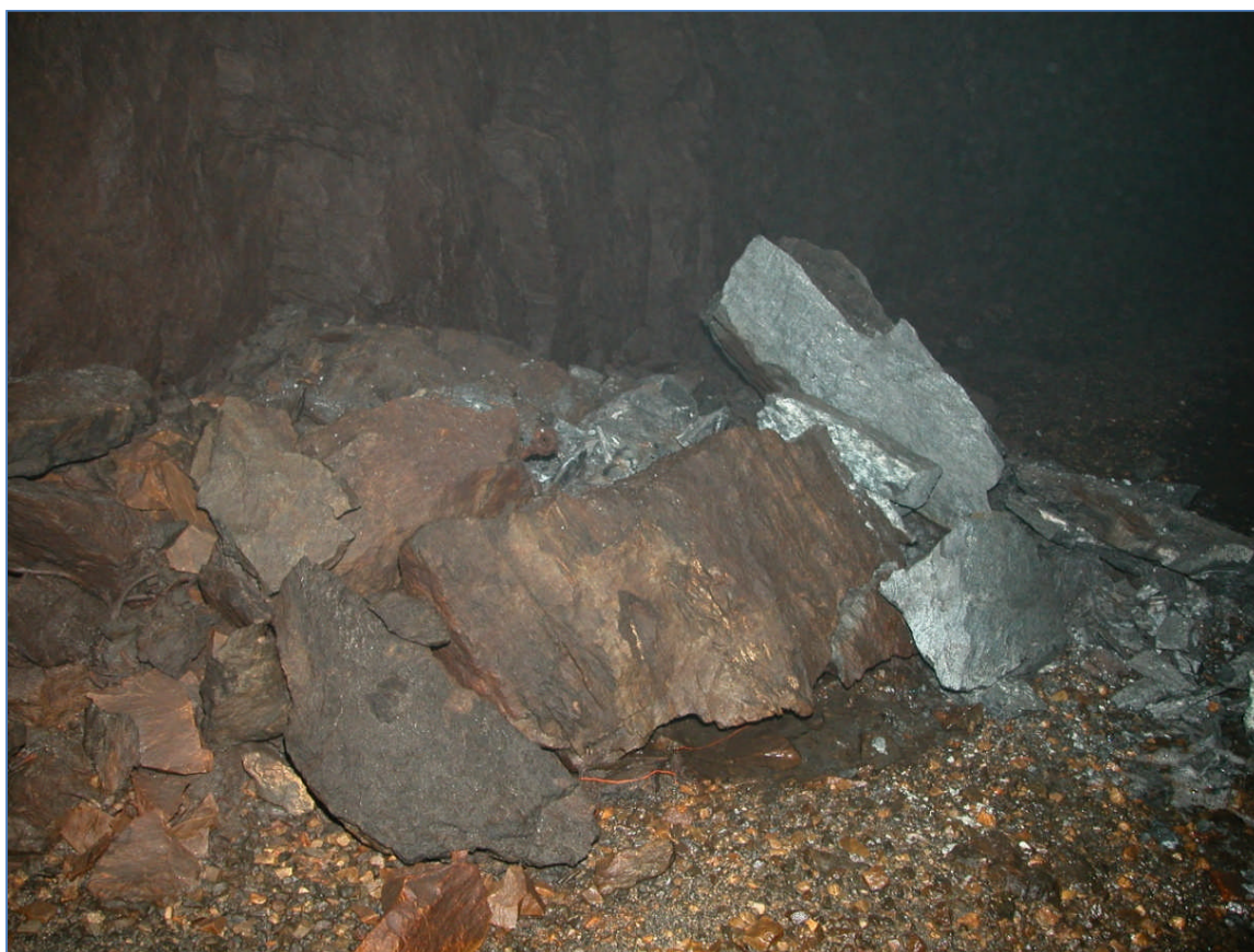
Figur 4.7: Nedfall i overføringstunnel oppstrøms side kryss Dukebotn [12]
