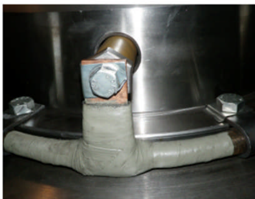
Kabelforbindelser fra aksling til poler
