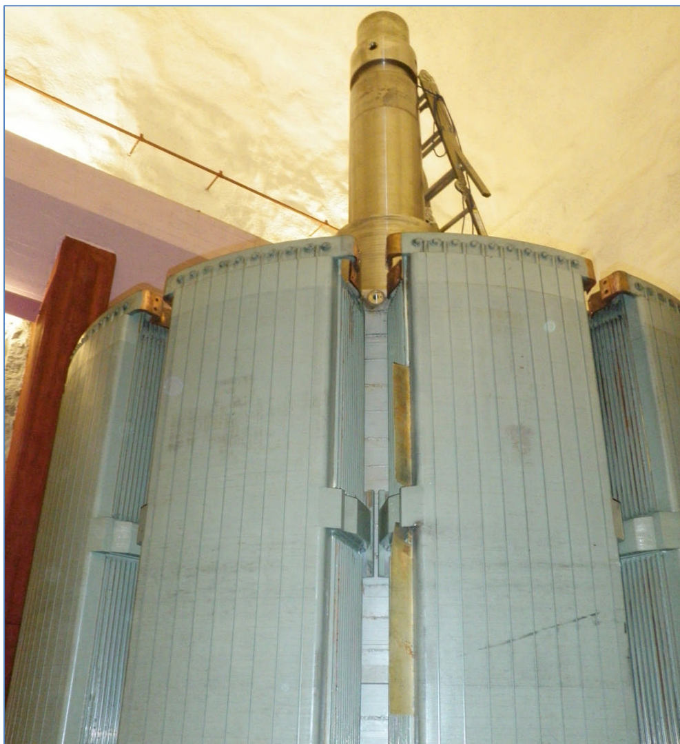
Figur 4.1: Utløftet rotor under stor revisjon av Steinsland kraftverk 2012 [10]
