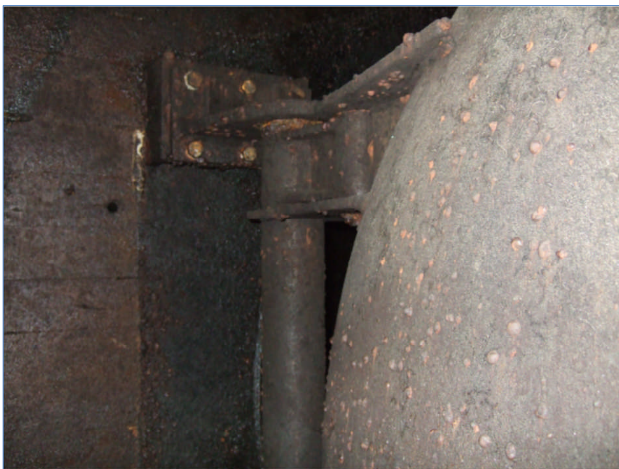
Figur 4.4: Rustknoller på hengsel for portblad på tverrslagsport i kraftstasjonen [11]
