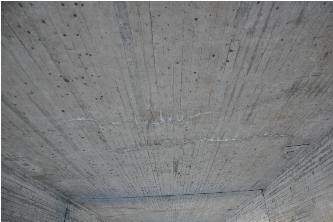
Figur 5.5: Svinnriss observert på undersiden av bruplata
