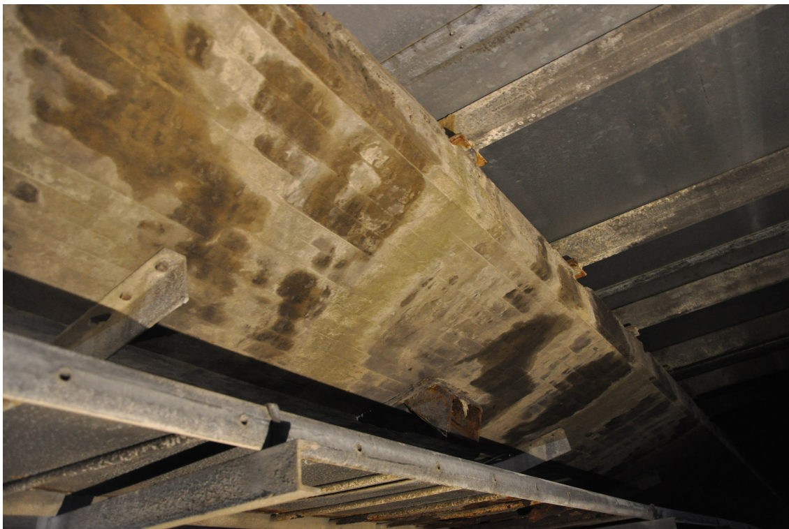
Figur 5.6: Fuktig bruplate under påhengt gangbane
