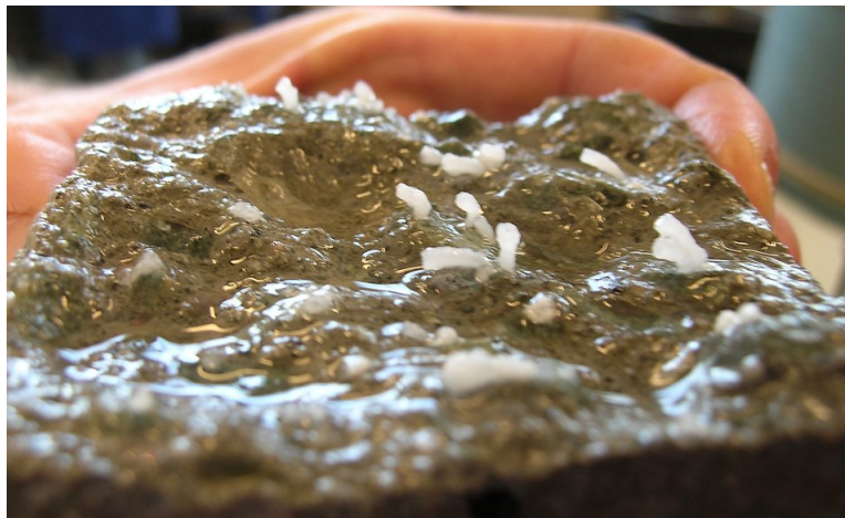
Figur 4.3: Bakgrunnen for krakeleringssiss er denne alkaligelen som popper ut av betongen
