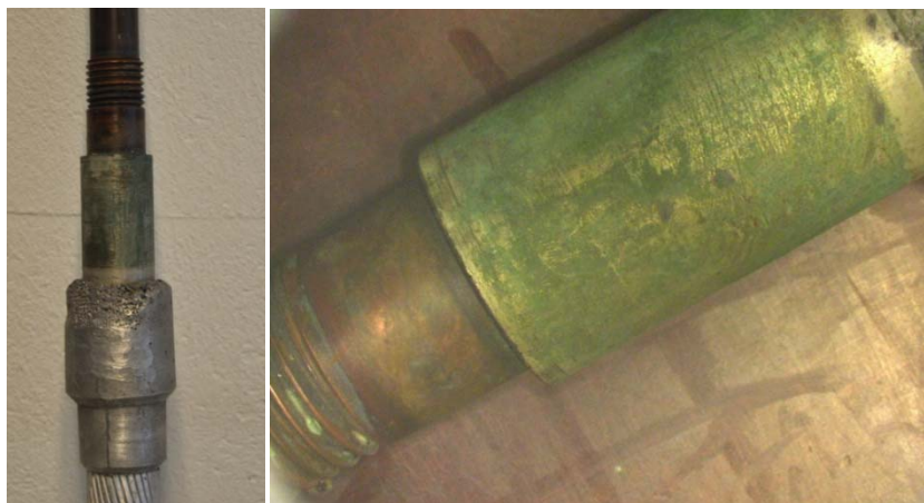
Figur 2 Toppbolt på havarert kabelterminering. Grønnfargen på bilde skyldes oksidasjonsprodukter fra kobber noe som er en klar indikasjon på tilstedeværelse av vann.
