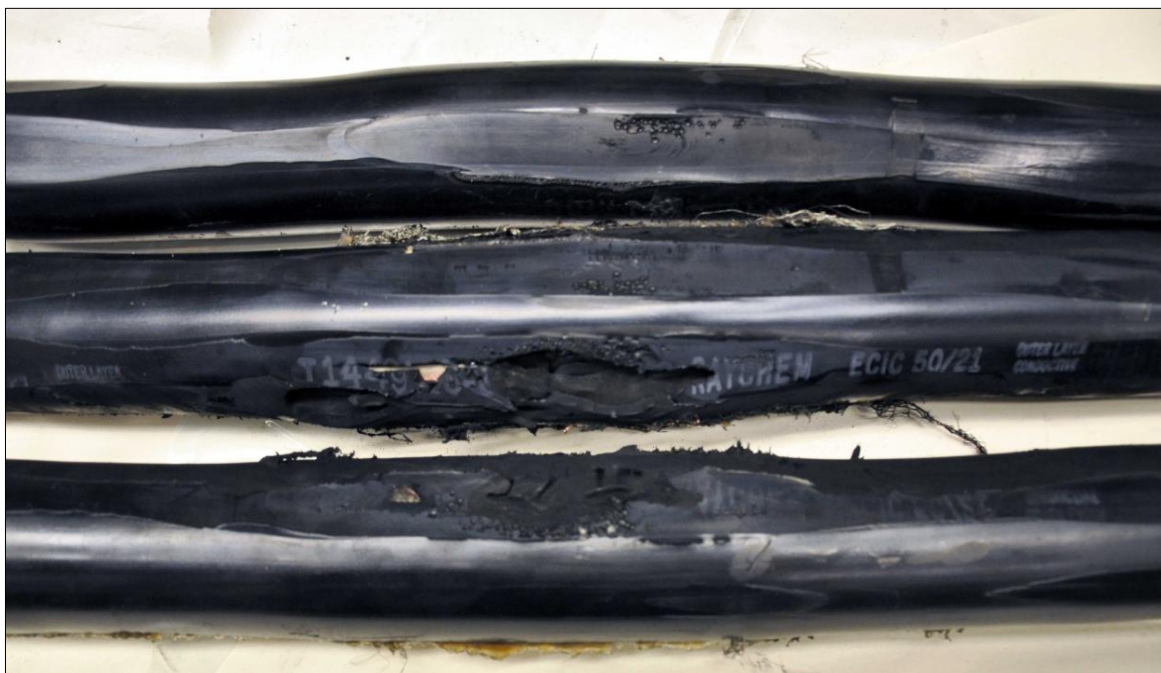
Figur 4-21: Kabelskjøt 4 – Feilfasen (Fase 1) vises midt i bildet. En ser tydelig tegn på at skjøtene har vært i klem. Overflaten på enlederskjøtene som har ligget inn mot de andre enlederskjøtene er tydelig sammenpresset.
