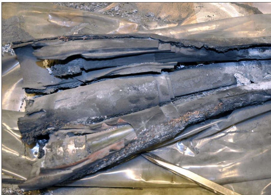
Figur 4-17: Ytre beskyttelseskappen er fjernet. Skjøtehylsene til skjøtene øverst og nederst i bildet var helt avbrent, mens den midterste delvis var intakt. Store deler av skjøtisolasjonen er oppbrent.
