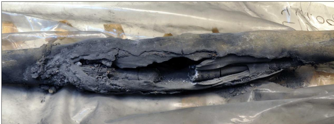
Figur 4-16: Kabelskjøt 3 etter havari i felt. To av skjøtehylsene er avbrent, mens den siste fortsatt var delvis intakt.
