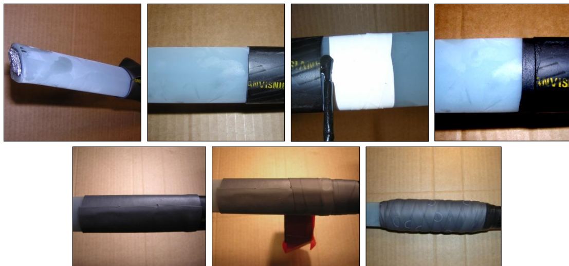
Figur 4: fremgangsmåte ved lagging av kabelendeavslutning. Bilde 1 og 2: Ytre halvleder fjernes. Bilde 3 og 4: Halvledende lakk påføres. Bilde 5: Feltstyrende duk pålagt. Bilde 6 og 7: Fjerning av hulrom.
