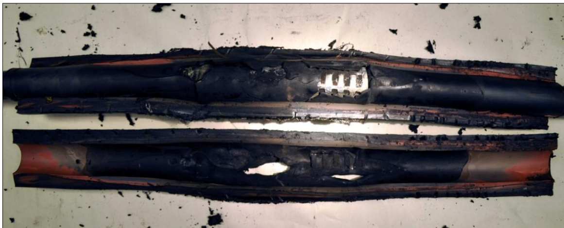
Figur 4-18: Kabelskjøt 4 - Skjøtehylsen rundt havarert enlederskjøt er splittet i to.
