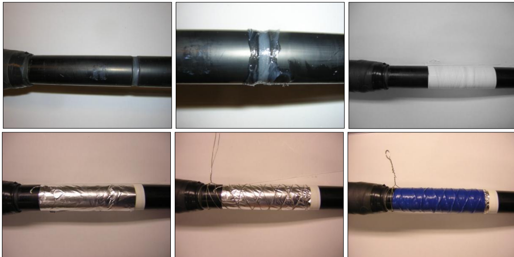
Figur 8: Fremgangsmåte ved laging av guard. Bilde 1: Et hakk i ytre halvleder pusses/skjæres ut. Halvleder må fjernes helt inn til kabelisolasjonen. Bilde 2: Hakket dekkes med silikonfett for å hindre hulrom i hakket. Bilde 3: Over hakket surres ett eller flere lag med teflon teip (avhengig av teipens tykkelse). Bilde 4: Aluminiumsfolie legges over teflonteipen, med overlapp over kabelens ytre halvleder på siden hvor en ønsker å lede bort lekkstrømmen (i dette tilfellet området under endeavslutning og kabel. På siden mot prøveobjektet legges aluminiumsfolien noen millimeter inn på teflonteipen for på å sikre at det ikke er kontakt mellom folie og ytre halvleder. Bilde 5: Aluminiumstreng surres stramt rundt aluminiumsfolien for å sikre at denne sitter stramt mot kabelen. Bilde 6: Elektrikerteip surres utenpå det hele, men noen millimeter innenfor aluminiumsfoliens på prøveobjektsiden. Dette laget fungerer bare som en ytre beskyttelse.
