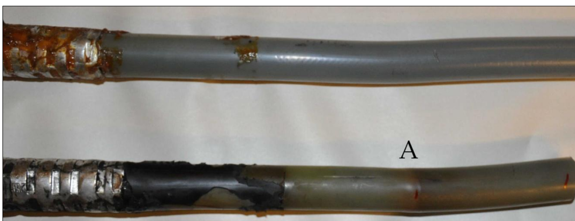
Figur 4-20: Kabelskjøt 4 - Fase 1(nede) - Fase 2(oppe) - Tydelig fargeforskjell på PEX-isolasjonen mellom havarert fase (nede) og frisk fase (oppe). A angir punktet hvor den feltstyrende hylsen sluttet. En ser tydelig en innsnevring av kabelens diameter i dette området.
