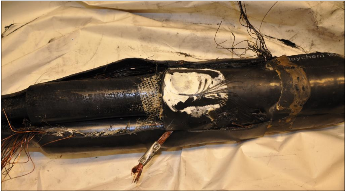
Figur 1: Den ytre kappen rundt skjøtene er delvis fjernet. Til venstre ser en noe av enfaseskjøtene.
