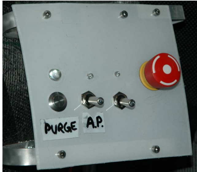
Figur 3.38: Bilde av kontrollpanel
