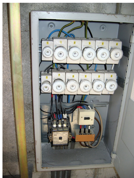
Figur 13-5: Tennskapet i Brøsetveien
