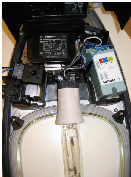
Figur 12-17: Philips Iridium armatur. Elektronisk forkobling med lampenode til høyre
