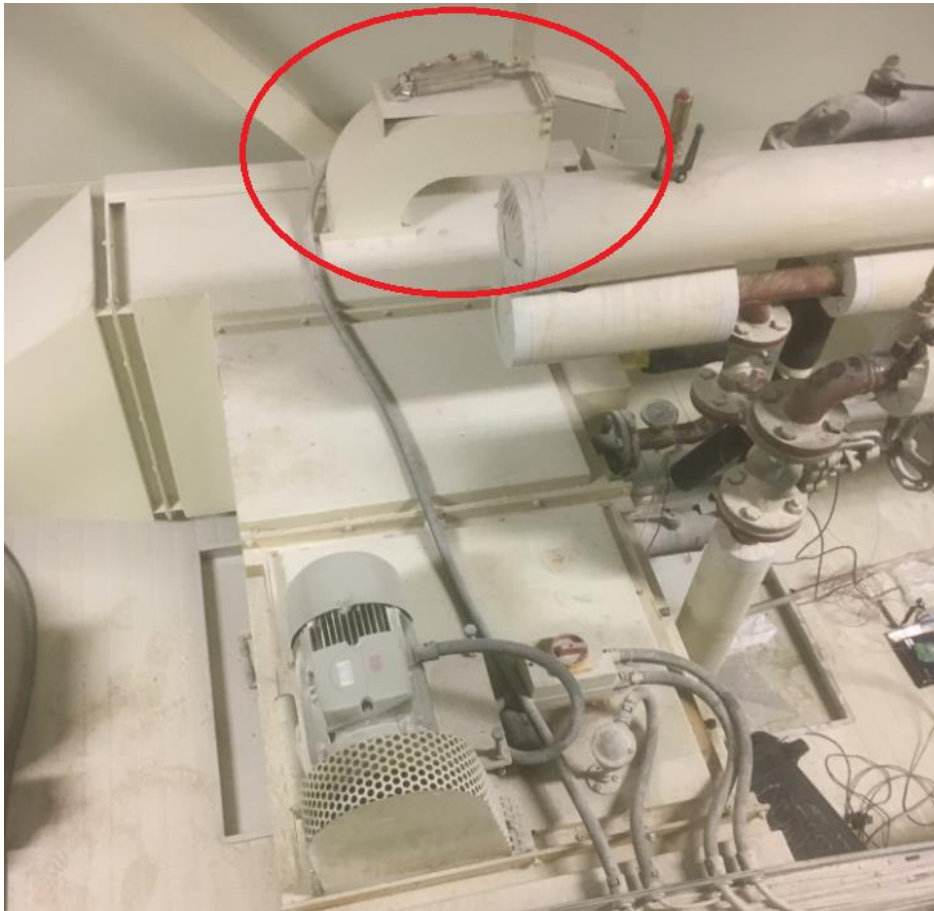
Figur 26 Vifteseksjon med inntaksspjeld
