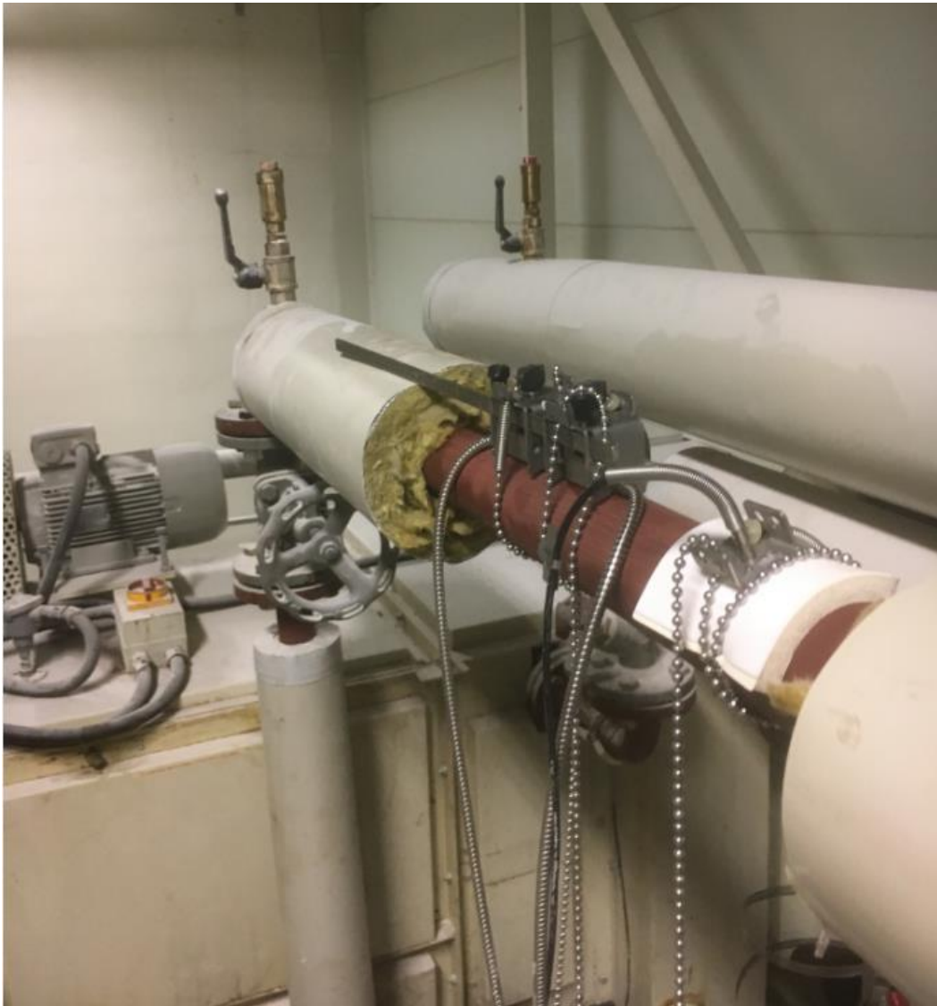
Figur 29 Energimåler montert på varmekrets
