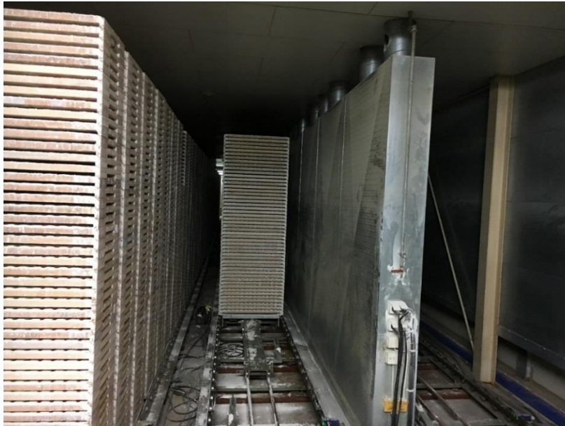
Figur 13 Tørkeskap 1 under oppfylling
