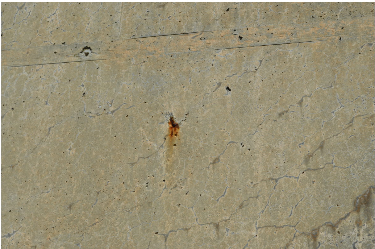
Figur 6.5: Rustutslag i landkar
