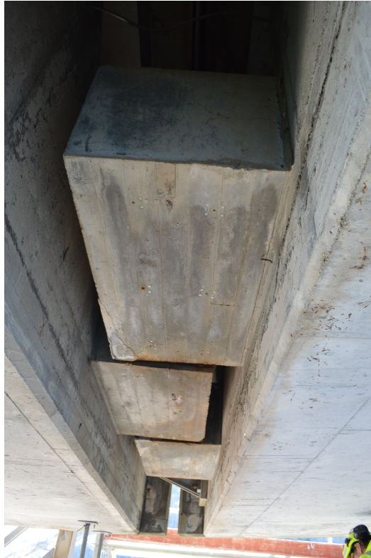
Figur 6.16: Korrosjon i betongen
