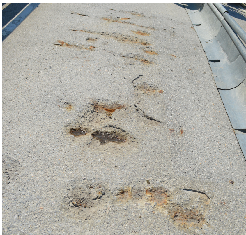
Figur 6.3: Korrosjonsskader i brudekket
