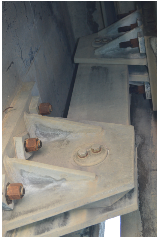
Figur 6.17: Korrosjon på skruer
