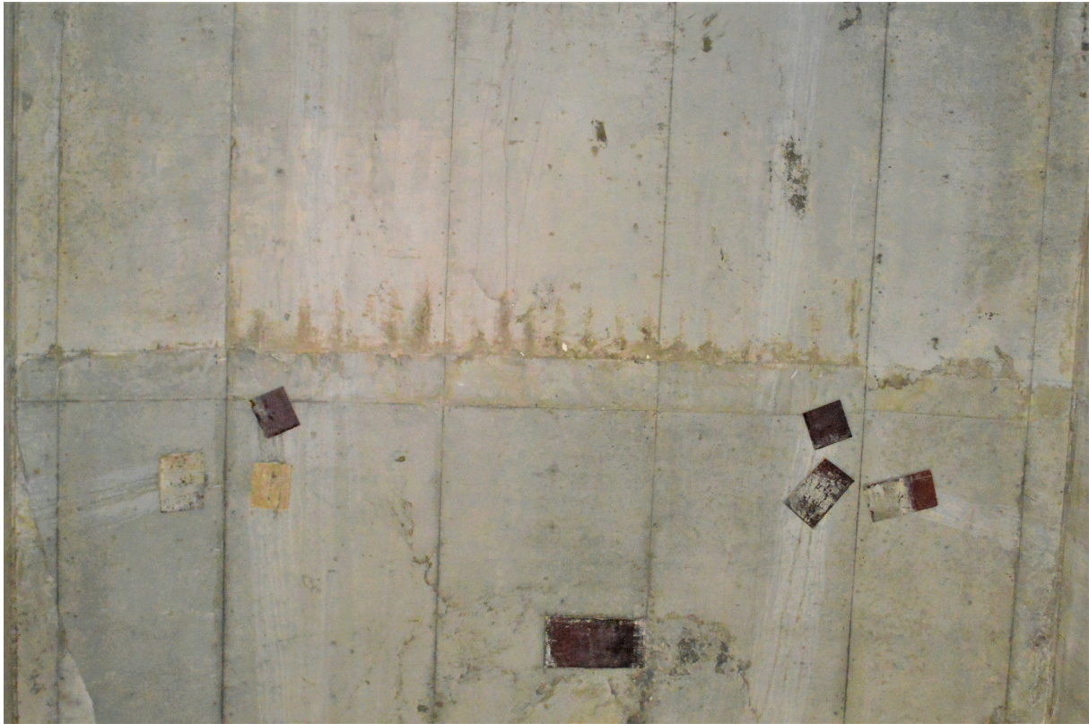
Figur 6.12: Antydning til korrosjon i overgang mellom to støpetapper
