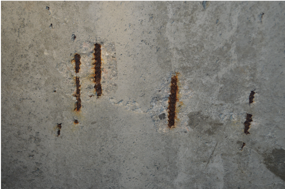
Figur 6.6: Eksponert vertikalarmering på innside av steg
