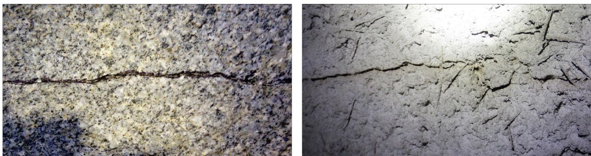
Figur 7.8: Venstre: Hydraulisk splitting av intakt berg (foto: Snorre Solli). Høyre: Sprekk i sprøytebetong (foto: Chhatra B. Basnet).
