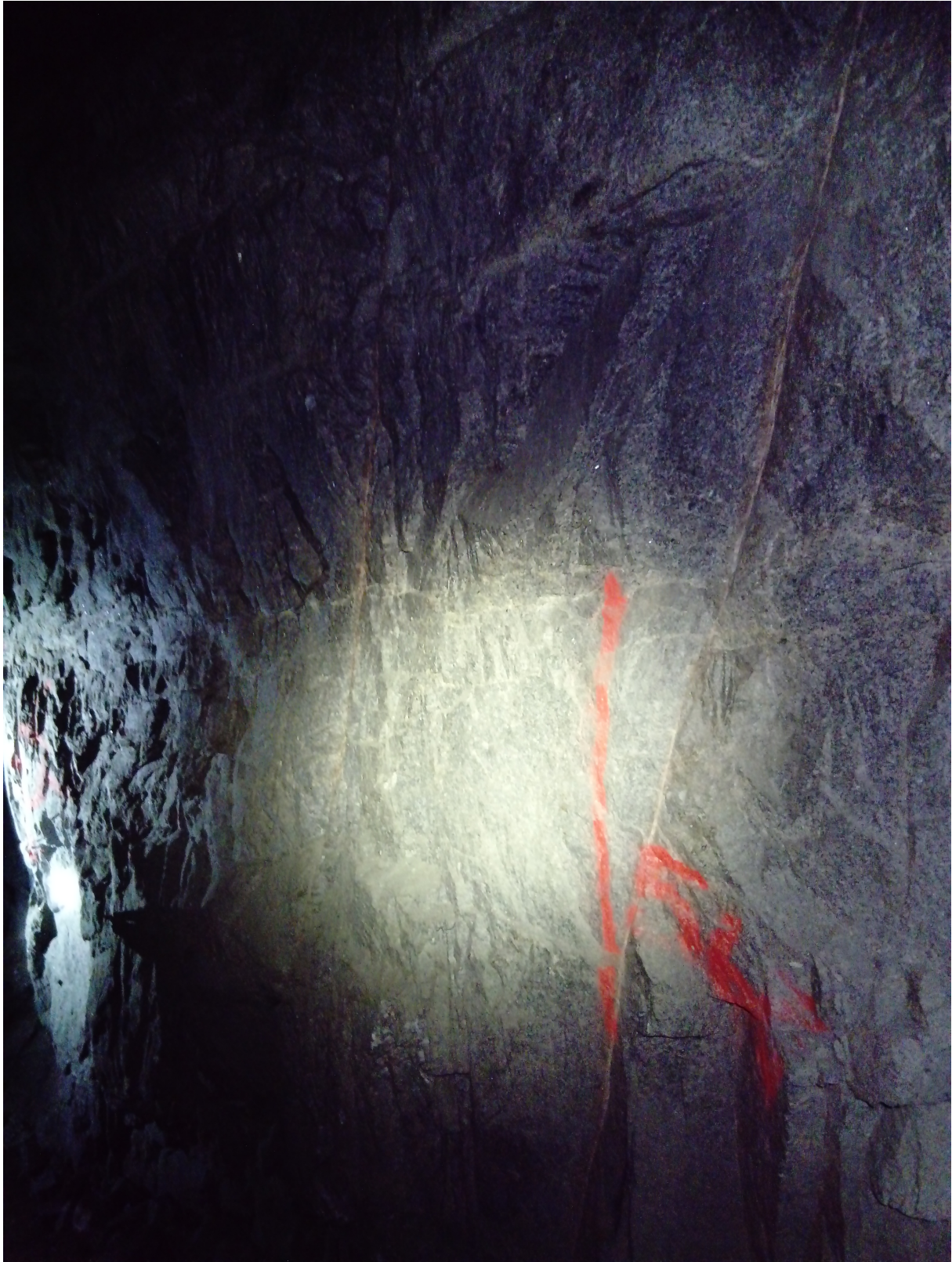
Figur C.9: Sprekk ved pr. 560 (foto: Snorre Solli).
