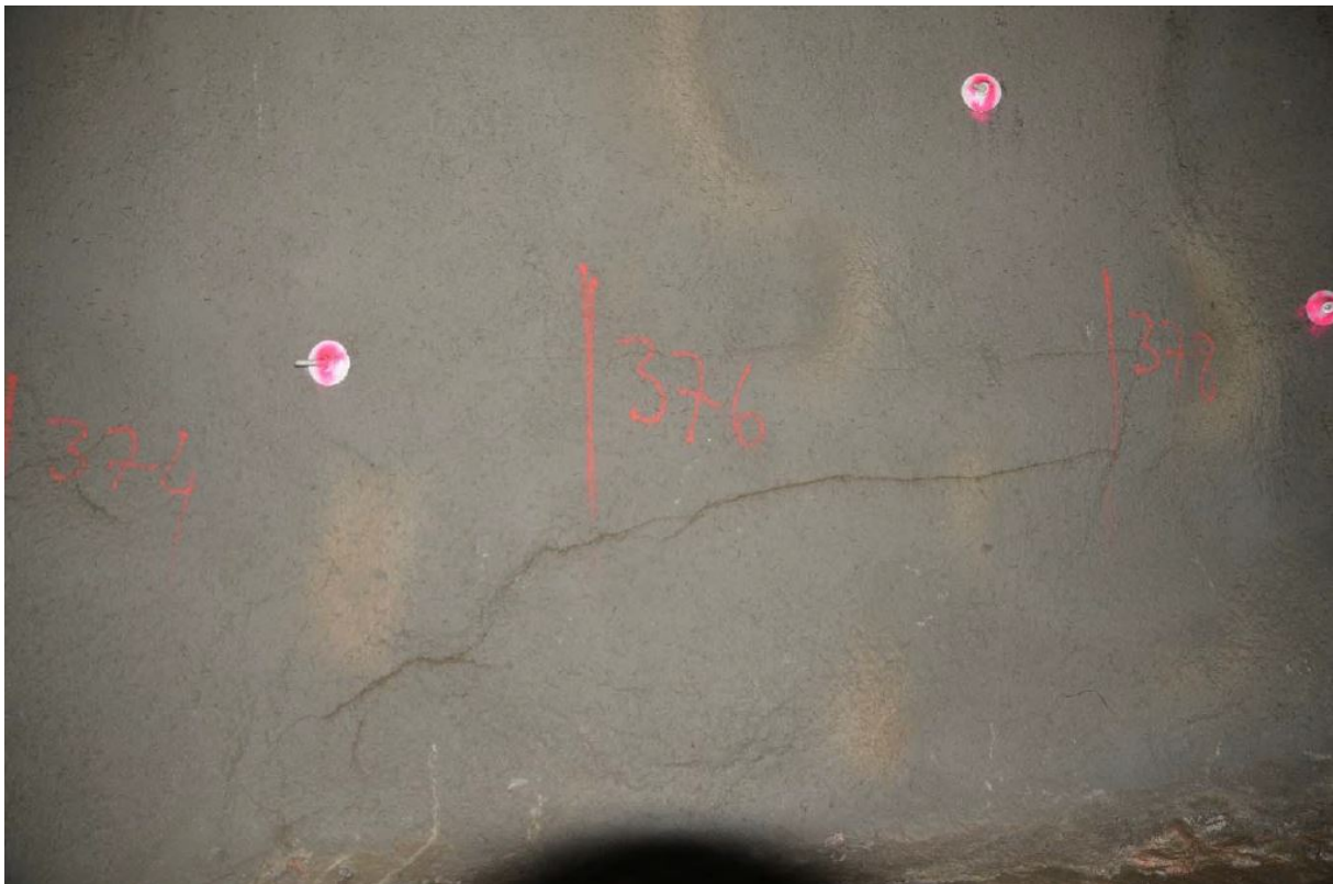
Figur C.8: Riss i sprøytebetongen ved pr. 374–378 (venstre vegg, motstrøms) (Jacobsen, 2016).
