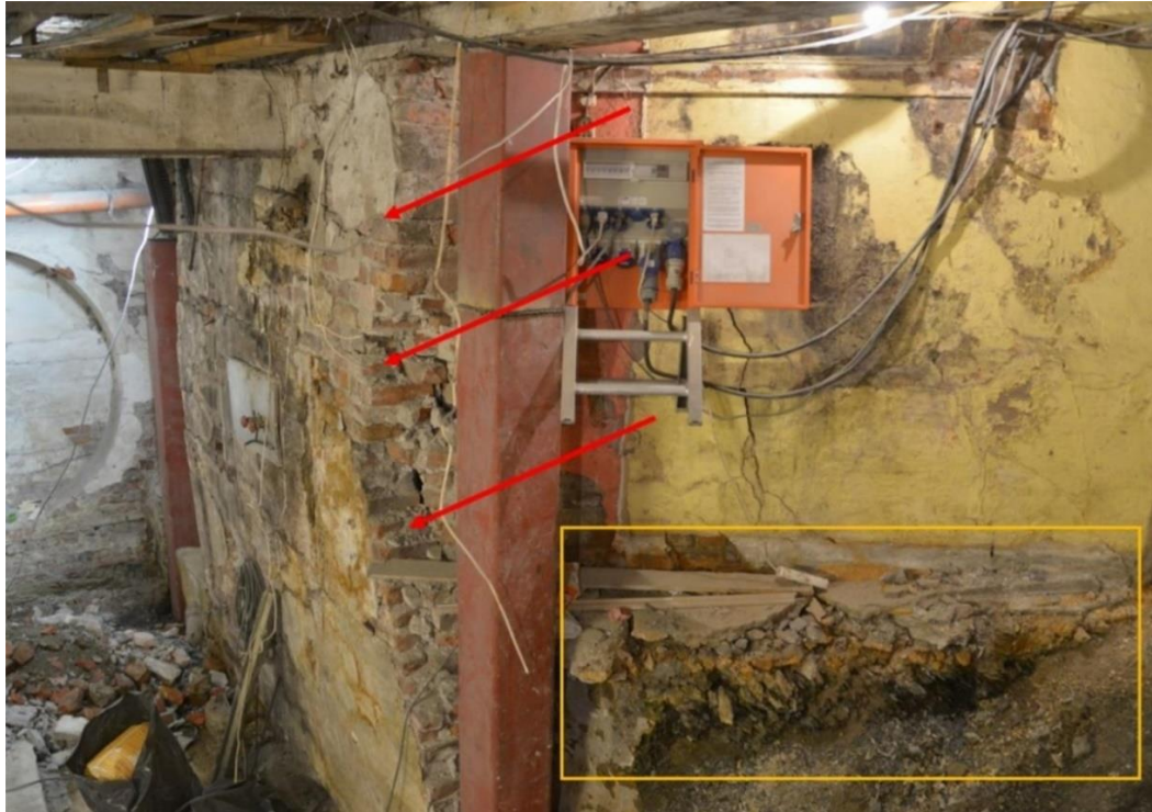
Figur 3.12 Skader som følge av svelling i alunskifer. Vegg presses ut på grunn av svelletrykket (røde piler). Huset er fundamentert direkte på alunskifer og vegg er på vei til å rase ut (gult rektangel). Etter NGI (2015b).
