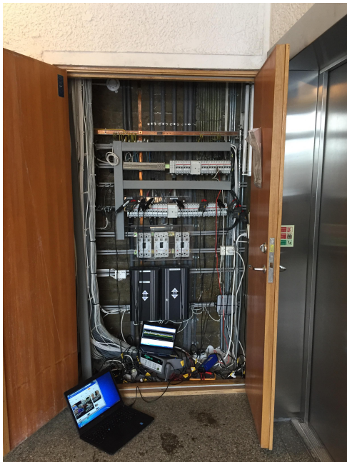
Figur 4.10: Oppkobling av måleutstyr på Geologibygget
