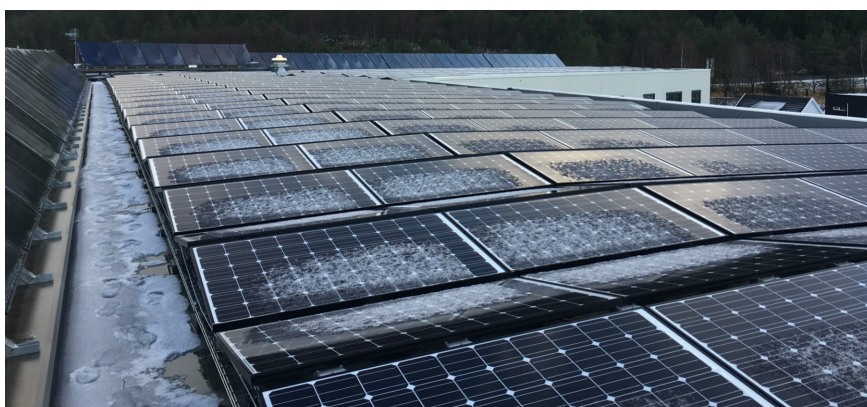
Figur 7.2: Energiproduksjon fra solceller og solfangere på Eidet omsorgssenter
