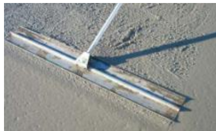
Figur 31: Dissing av betong [44].
